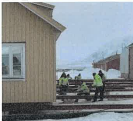
Alt gikk på skinner da Butikken ble flyttet ved hjelp av taljer og håndkraft under refundamenteringen. Foto: Ellen Kristine Opheim.
