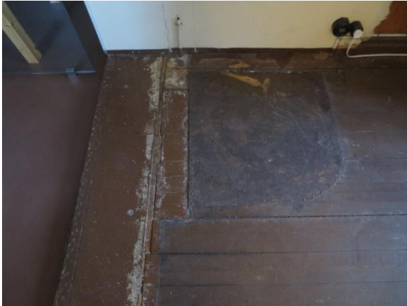
Nr. 16 Telegrafan har et spennende gulv: Til venstre ligger ny linoleum, til høyre opprinnelig bordgulv fra 1918 med blikkplate under tidligere ovns plass.
