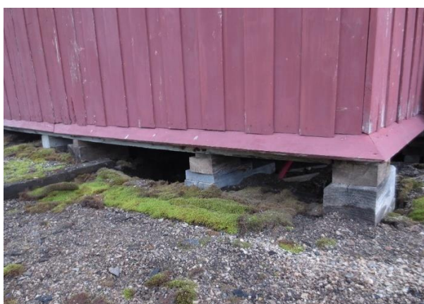
Nr. 5 Arbeiderbrakka. Fundament av treputer, biter av boks/plank (sekundær løsning). Putene er enkle å justere, men ustabile når de stables i høyden. Nedsynkning og utglidning er en utfordring.
