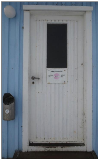
T.v.: Nr. 18 Trønderheimen. Typisk dør fra 2. driftsperiode, ombygget ramtredør med stående skyggepanel og smalt glassfelt. Huntonittplate på innsida. Innadslående dører byr på utfordringer med vanninnsig.
