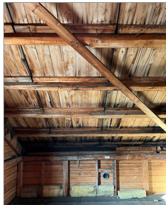
Nr. 33 Mellageret. Synlig takkonstruksjon fra 1919. Et sjeldent bevart eksempel på åstak med taktro av prefabrikkerte lemmes.
