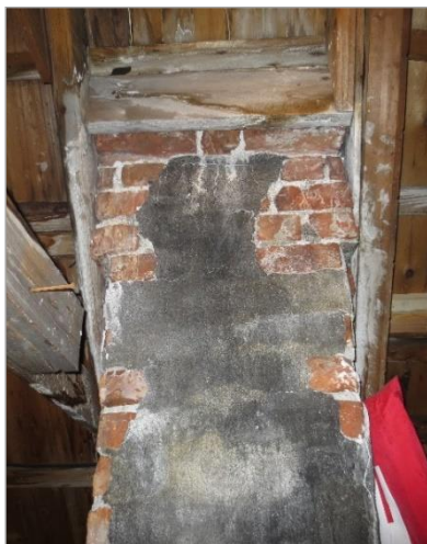
Nr. 23 Blått hus. Pipestokk med rester av gammel puss på loft. Denne bør bevares uten tiltak, løs puss fjernes ved behov.
