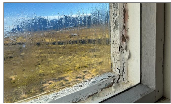
Nr. 16 Telegrafan. Vindu øst, mye kondens på ytre glass. Krever tiltak, eventuelt lufting ytre ramme.
