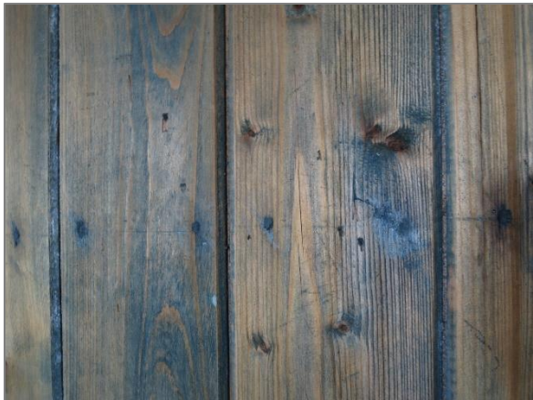
Nr. 5 Arbeiderbrakkka. Blålig impregnering bak blikkplate. Avfasete kanter er fargemettet, og spikerhodene er blå. Impregneringen må være påført etter monteringen av panelet på lemmene.
