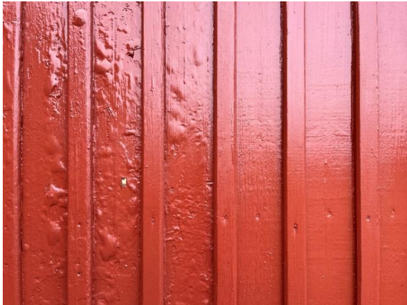
Nr. 28 Samfunnshuset ett år etter maling. Ekstrem blæring på eldre kledning (lite på ny). Dette skyldes fet linoljegrunding som ligger innerst, ref. Brønne 2023, trolig forverret av noe mangelfullt grunnarbeid og altfor tykt påført maling.
