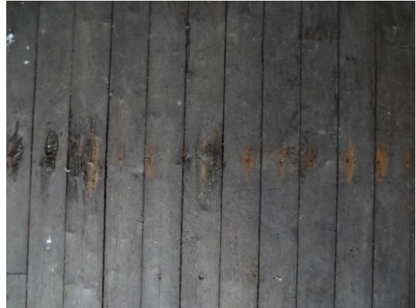
Nr. 5 Arbeiderbrakkka. Avdekket tregulv med ulike slitasjespor. Spikersømmer etter huntonittplater fra 2. driftsperiode. Fukt langs sømmene har gitt små skader, som forteller en historie om endring.
