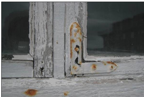
Typisk eksempel på slitt maling og utett kitt. Rust og løse stifter kan tyde på råteskader bak beslag. Behov for vedlikehold av maling og kitt.
