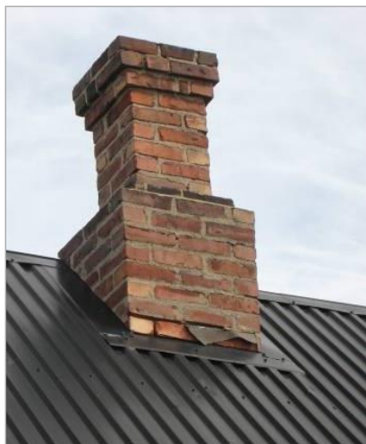
Nr. 80 London 1. Frostsprengt tegl ved beslag. På sikt bør frotskadd teglstein skiftes og beslagløsningen forbedres.
