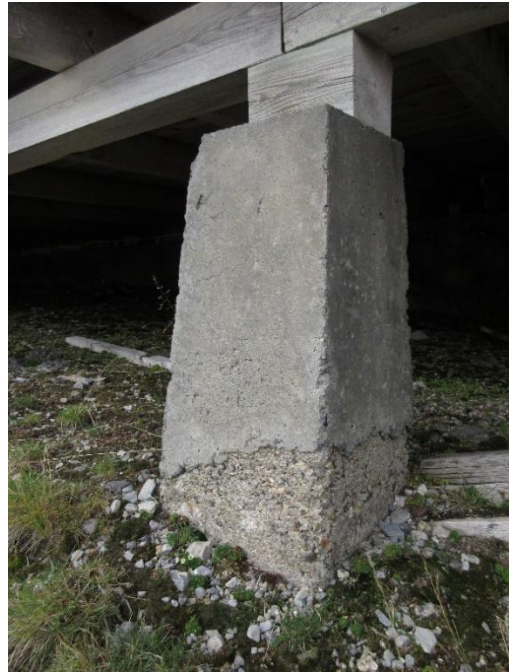
Nr. 33 Mellageret. Opprinnelige pilarer av lokalt framstilt betong ses i nedre del. Senere reparasjon med moderne sement gir et helt annet uttrykk. Man bør tilstrebe større likhet ved valg av reparasjonsmørtel.
