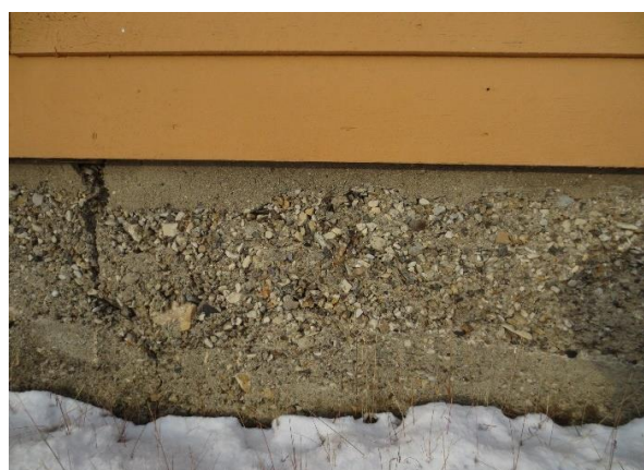
Nr. 20 Gult hus, støpt ringmur 1919. Fundamentet ligger grunt i det aktive laget, risiko for setninger og sprekker. Betongen er nedslitt og tilslaget eksponeres, bevart overflate oppunder kledningen.
