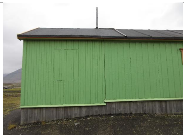
Spor i kledning etter vindu mot øst i kjøkkenet. Opprinnelig del av brakka t.h. har bevart et par gamle lekter på taket. Disse har høy verneverdi og må beholdes.
