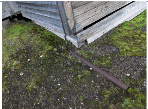
Vannrøret går under nordre bislag med utløp til terreng, antatt en historisk løsning fra 1958–63.
