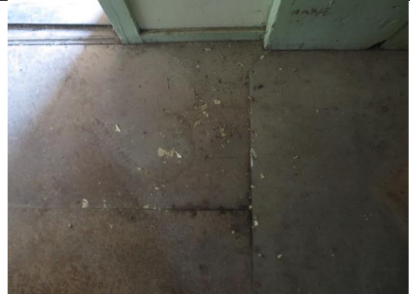
Gulvet er kledd med huntonittplater, typisk for 2. driftsperiode. Til høyre del av blikkplate under ovnsplass hjørne nordvest.
