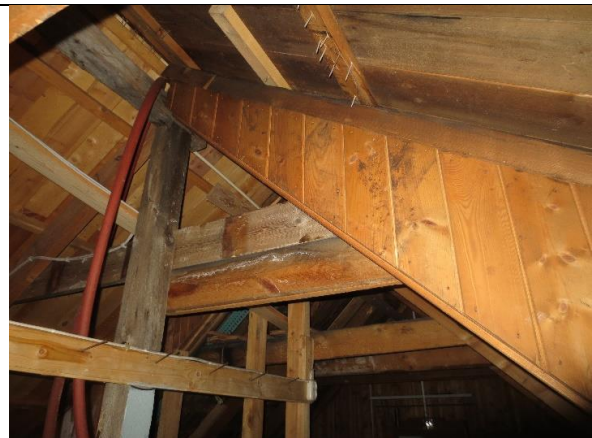
Sett opp langs oppløft mot mønet. Taktraa er delvis fornyet som følge av ombygginger.
