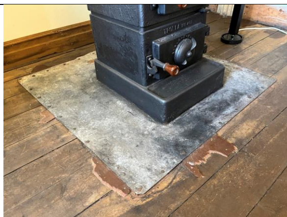
Dagens ovns plass sørvest i telegrafrommet, med bevarte rester av brun linoleum fra 2. driftsperiode over det opprinnelige bordgulvet. Ovn og blikkplata er bevart fra 2. driftsperiode.
