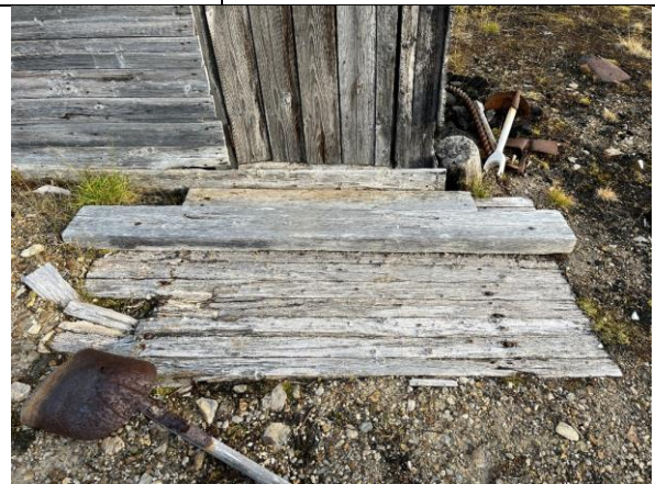
Plank nedlagt i bakken foran inngangsdøra, med råte og brekkasjeskader. Sårbar for tråkk.
