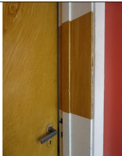
Ådring på dør, og delvis avdekket ådring på karm.
