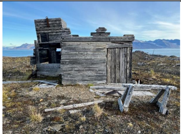
Fasade sør, med inngangsdør og en sagkrakk i forgrunnen. Luftesjakta står noe skakk t.v.
