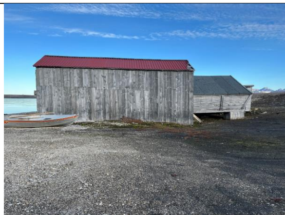
Fasade mot sør, tilbygget naust med røde stålplater på taket. Papptekking på selve kullpramnaustet.
