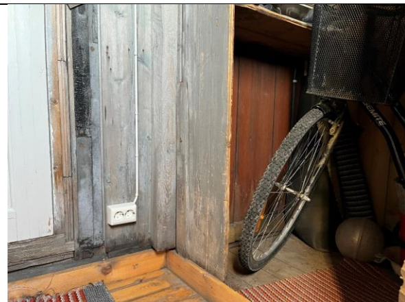
Utsnitt bislag og østre bod, t.h. åpen boddør. T.v. dør til kjøkken. Nyere bordgulv med lakkerte bord i opprinnelig del av bislag.
