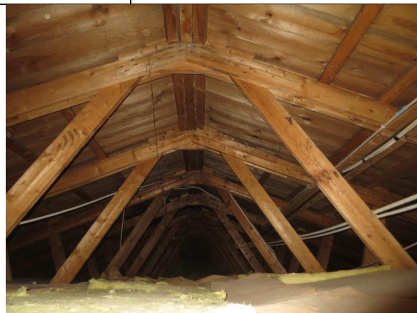
Loftet er bevart med opprinnelig sperrebind, såkalt W-takstoler. Nyere Glava-isolasjon er lagt over etasjeskillet. Tilkomst via luke i korridor.
