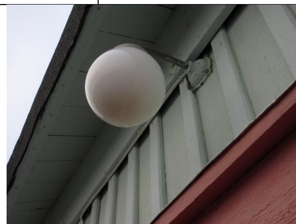
Eldre lampe over dør, antatt opprinnelig fra 2. driftsperiode/1960-tallet. Staget fra konsoll til kolbe er rett (ikke svai som på nyere varianter).
