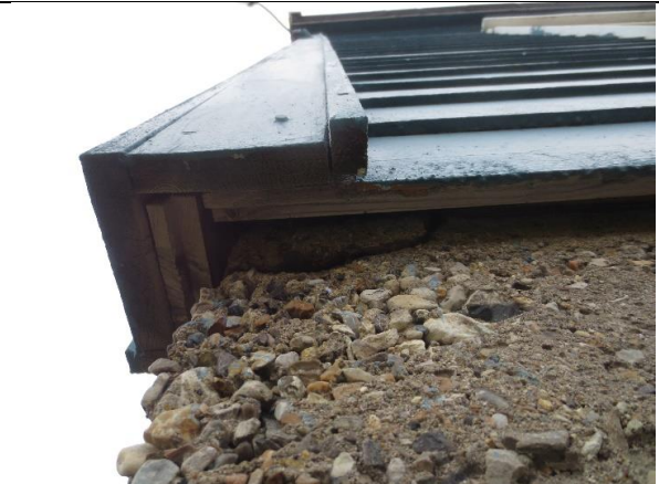
Detalj av grunnmur, der betongoverflata er slitt vekk og grov grus i tilslaget avdekkes. Ny kledning er lagt utenpå det opprinnelige vekselpanelet, som i nr. 21 Hvitt hus.
