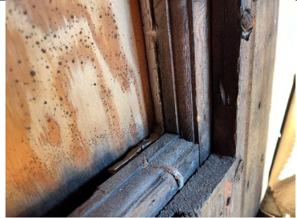
Blendet vindu mot nord, gammel ramme med staffprofil, srosser/glass mangler.
