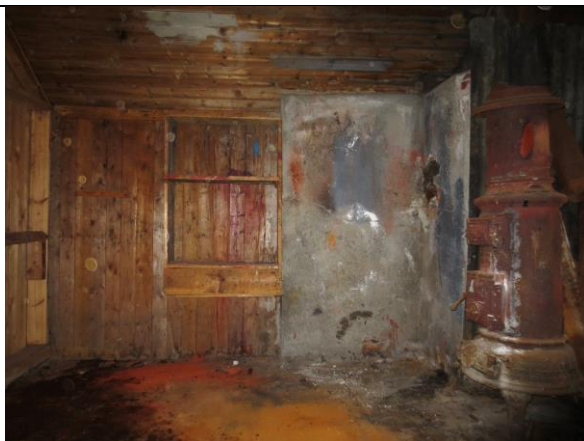
Mot nordveggen, til høyre brannmur og jernovn, som står i overgangen mot det smalere østre huset (til høyre for bildekanten).
