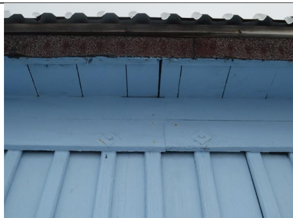
Detalj av takutstikk. Rød takpapp stikker ut under den nyere taktekingen med korrugerte stålplater.
