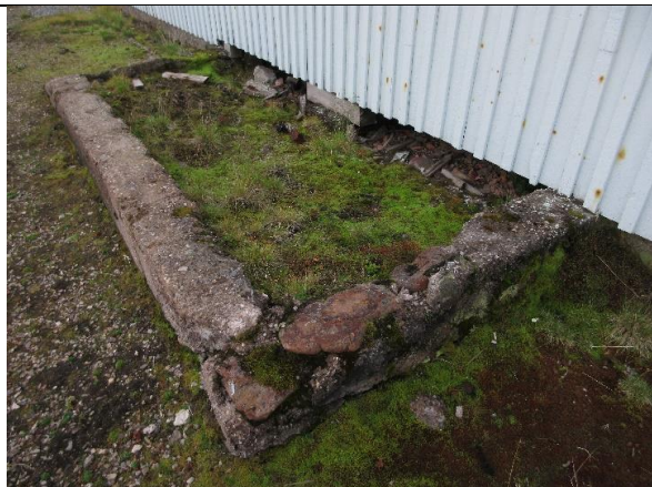
Detalj av betong grunnmur anno 1919. Sparebetong med store steiner i muren og ingen armering.
