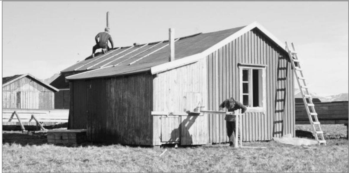
Under restaurering 1987. Hovedhytta ble forlenget mot sør i 2. driftsperiode, kjøkken med vindu. Opprinnelig bislag på seksmannsbrakkka ble revet da tilbygget ble oppført. Mot vest ble det oppført et tilbygg med pulttak, med luker for kullbinge og bøttedo i sørveggen. Foto: P.K. Reymert, Svalbard museum, SVF 23583
