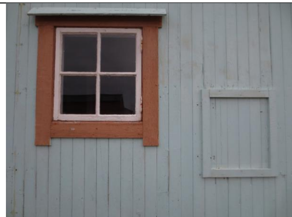
Opprinnelig vindu og tett luke i bislagets vestvegg. Luka har trolig gått inn til en kullbinge.
