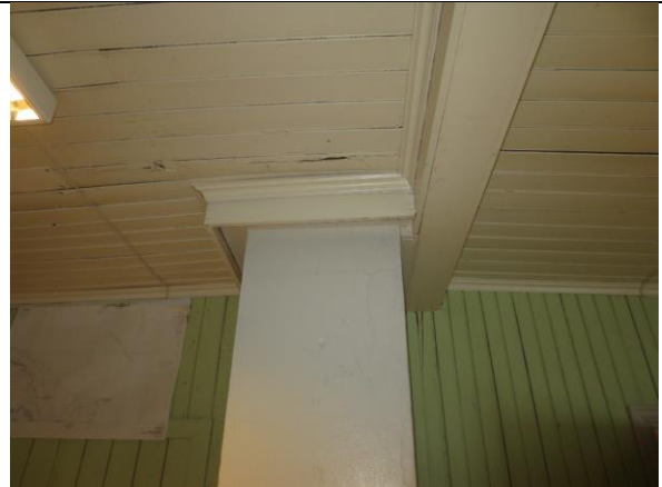
Typisk interiør i 1. etasje sett mot innervegg (bakside korridorvegg). Opprinnelig pløyd staffpanel på vegg og himling. Svært store setningsskader og heng på pipestokken. Pipestokk oppmurt i 1920-åra.
