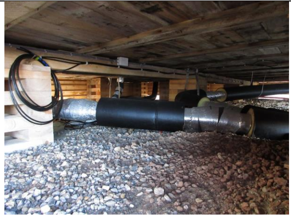
Huset er satt på nye drenerende masser, med god lufting og plass til rørføringer.
