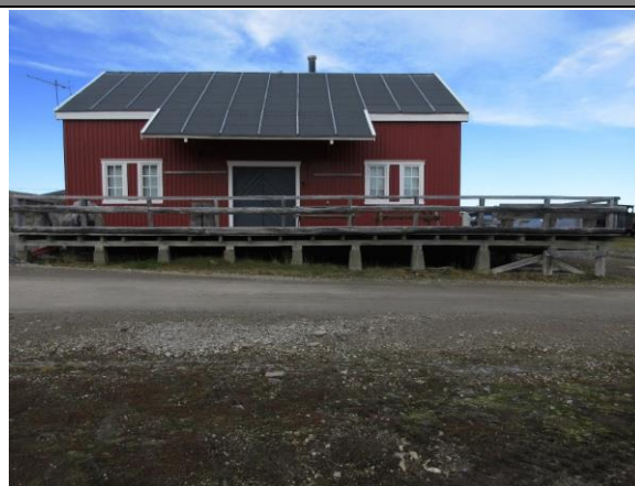
Fasade sør. Platting og skjermtak er fornyet i 1992, men er opprinnelige løsninger. Opprinnelige vinduer og port er bevart. På taket er det tradisjonelle lekter.
