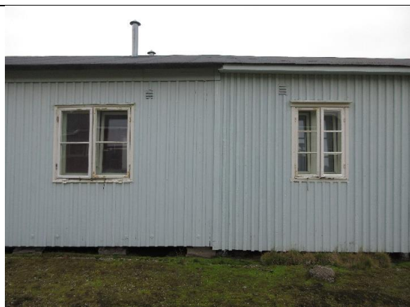
Fasadeutsnitt sør: brakka fra 1945 til venstre og tilbygg 1949 til høyre. Begge byggetrinn er bevart med lektepanel og vinduer, men noe ulik detaljering på kledning, vinduer og takutstikk.
