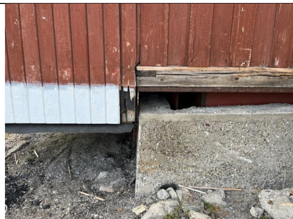
2024: detalj nordvegg i østre bislag. T.h. opprinnelig bislag med vekselpanel og ringmur. T.v. tilbygg med pløyd faspanel og pelefundament, nå av stål.
