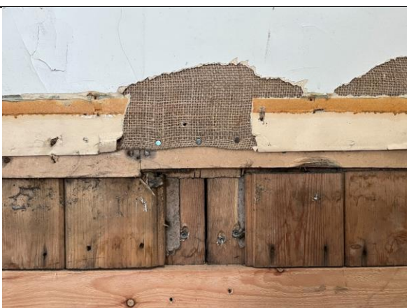
2024: Under nyere utlektet panel i stue avdekkes strie/tapet, som er spikret utenpå huntonittplater.
