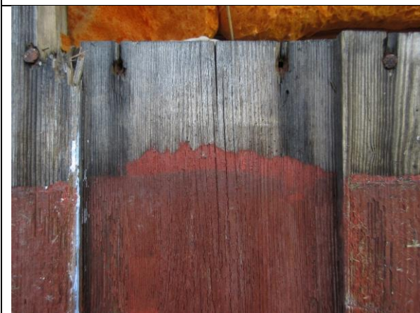
2024: Opprinnelig vekselpanel har to nyanser rød maling, den friskeste er innerst. Umalt panel bak gerikt.
