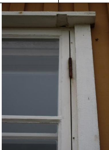
I øvre vannbrett ses utsparring for å kunne løfte av sidehengslet ramme.
