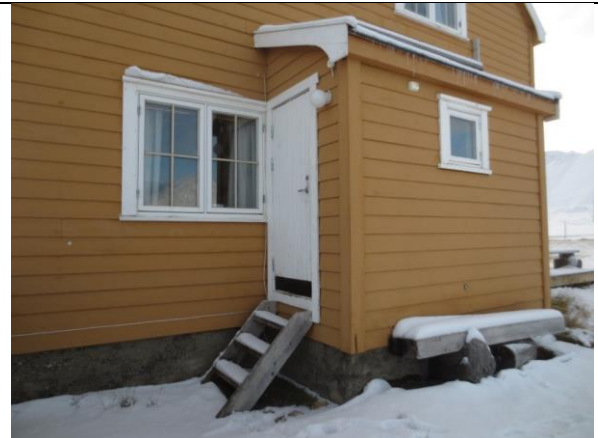
Detalj av bislaget mot vest, med støpt grunnmur anno 1919. Liggende kledning fra 1957, nyere vinduer og dør.
