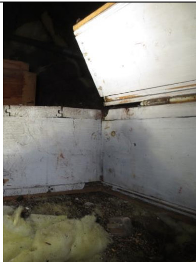
2023: Detalj av isolert loftsluke, snitt gjennom loftsgulv av tynne pløyde bord og luke med eikenøtthengsler, typisk for 1919.
