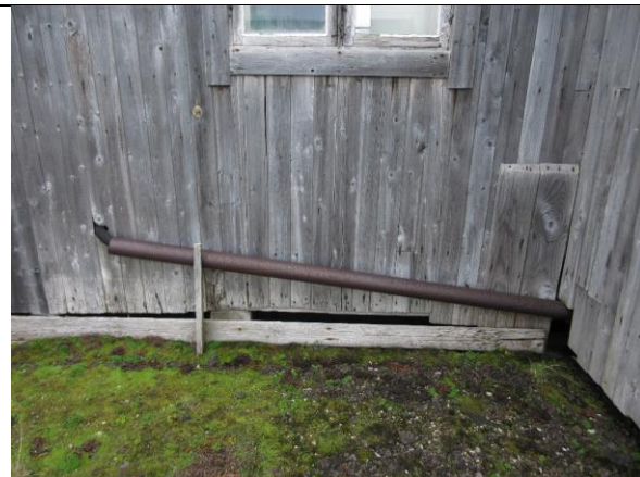
I midtfeltet på østveggen kommer et vannrør ut fra utslagsvasken i kjøkkenet. Dette var trolig skjult bak utlektet liggende kledning, før denne ble fjernet i midtfeltet ca. 1991.
