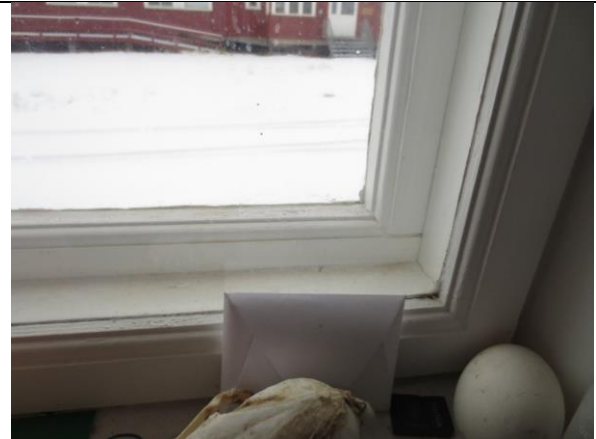
Detalj av liggende vindusramme mot nord, med opprinnelig ytre ramme med staffprofil og varevindu.
