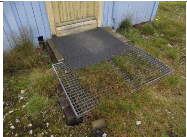
Tretram og nyere stålrister på bakken foran inngangen i sør. Dette er en nyere løsning som avviker noe fra eldre tram. Fundament av boks/peler i bakken t.v.
