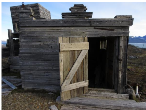
Fasade sør. De fastspikrete stabelene av bord-/plankebitene over tak har uviss funksjon.
