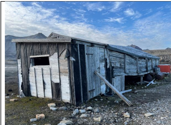
Tilbygget rom på kullprammens østside, med et vindu (uten glass) og dør. Papp og lekter på veggene er dels avrevet.
