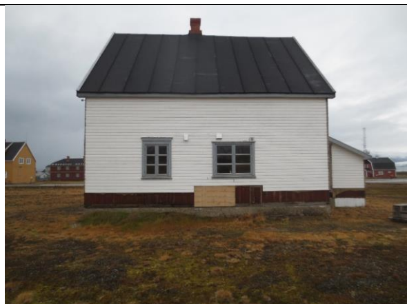
2023: Fasade sør. Merk de to ulike vindusformatene. Her ble trolig et opprinnelig vindu fra 1919 beholdt ved moderniseringen i 1959. Begge vinduene ble fornyet med isolerglass i 1988.
