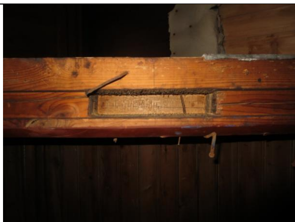
Detalj av sliss for opprinnelig stender i veggen mellom husene, jf. bildet over. Dette var opprinnelig yttervegg i det østre huset/lemrakka.
