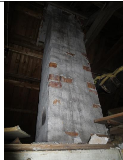
2023: Opprinnelig pipestokk med tynt pusslag.
