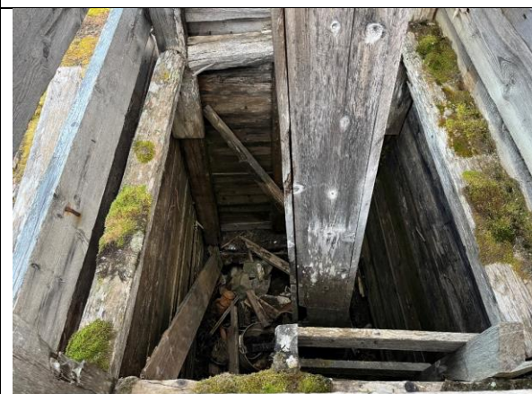
«Interiør» i luftesjakta, som dels er fylt av skrot og gjenstander. Mosegroing bør fjernes jevnlig.
