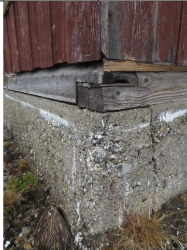
2023: Opprinnelig bunnsvill er skjøtt på halv ved i hjørnene. På høyre side ses rester av opprinnelig skrå vannbrett, som ble brukket av ved montering av ny liggende kledning i 1959.
