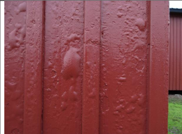
Etter siste oppmaling i 2023 er det ekstrem grad av linoljeblærer. Malingen er dessuten for tykt påført.
