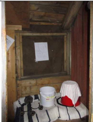
Vestre tilbygg, dobenk med trelokk under kledet.
