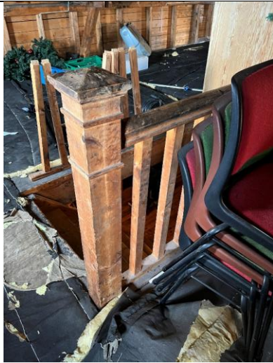
Trappa har rekkverk og fint utformet stolpe av samme type som i samtidige hus tegnet av arkitekt Flor. Muligens montert her senere. På motsatt side står spilene løse uten håndløper.
