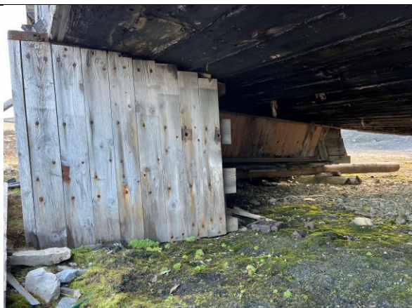
Kullprammen står delvis på fundamenter av krysslågt boks, som er kasset inn.
