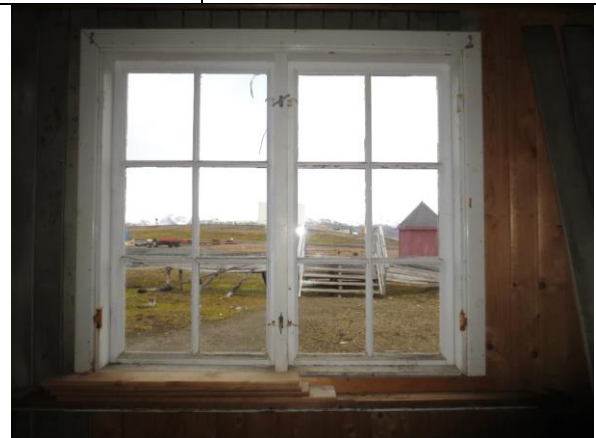
Opprinnelig vindustype mot nord, antatt med karm og rammer fra 1918. Senere innsatt varevindu er fjernet.
