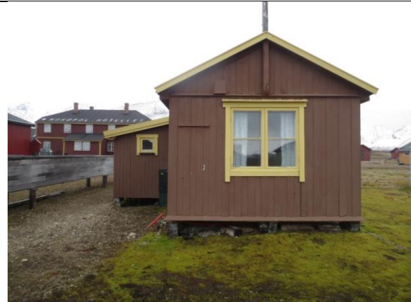
Fasade nord, opprinnelig brakke. Vinduet ble fornyet i 2. driftsperiode og har høy verneverdi. Opprinnelig i 1918 var det seks ruter i hver ramme.
