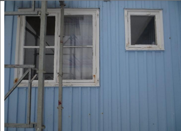
To opprinnelige vinduer fra 1945 er bevart like øst for bislaget mot nord: til dametoalettet (tofags vindu) og til bøttekottet.
