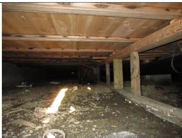
Under huset er det forsterkende bæring av sviller/stolper. Trebjelkelag med stubbloft. Merk kondensmerker rundt spiker, typisk fenomen rundt spiker i kalde omgivelser.
