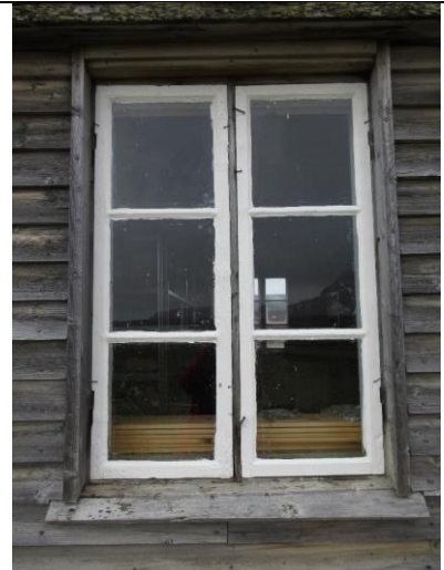
Tre vinduer mot vest er nylig restaurert, spikret fast uten hengsler. Se bildet nedenfor.
