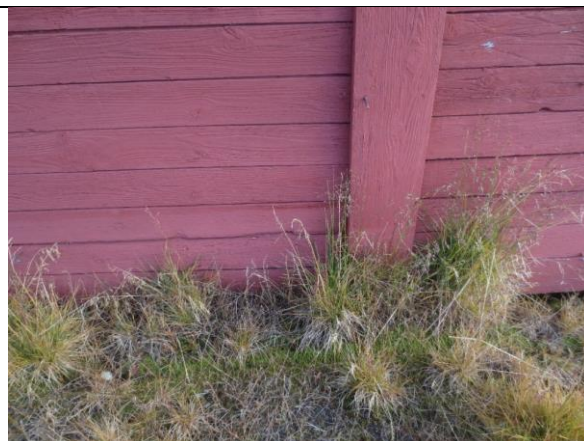
Vestre del: Vegg med vertikalt dekkbord over panelskjøt fasade sør. Her ligger terrenget høyt og fører til fuktansamling og fare for råteskader.
