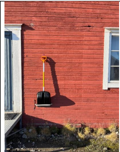
Vertikalt spor i vegg til høyre for hovedinngangen viser avgrensningen etter et eldre bislag. Dette ble oppført en stund etter 1917, foran en rødmalt fasade med nummerskilt.
