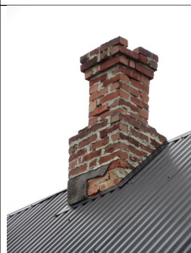
Pipa anno 1950 har omfattende fugeutfall og nedfall av teglstein.
