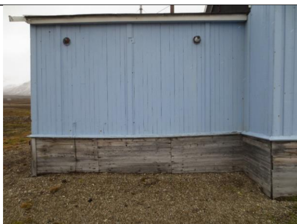
Fasade nord i bygningen fra 1918. Vertikale dekkbord antyder muligens inndeling i elementer, to ca. 1,5 meter brede felt med smalere felt på sidene. To rester av antenneinntak i vegg.
