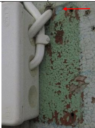
Avdekket faasademaling bak el-boks ved dør: ytterst lys blå (rød pil viser ubleket rest), deretter lys grønn, og innerst rødbrun maling.
