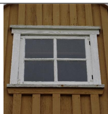
Gammelt vindu i østre gavnl, nå fastspikret. Spor etter tidligere hengsler på siden av ramma tyder på endringer.
