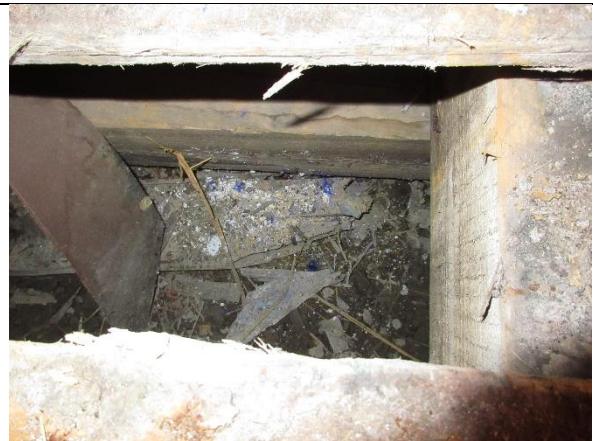
Glimt ned gjennom hullet i gulvet i vestre bygning (nå del av malerboden). Det er kraftige bjelker og god lufting under bordgulvet.
