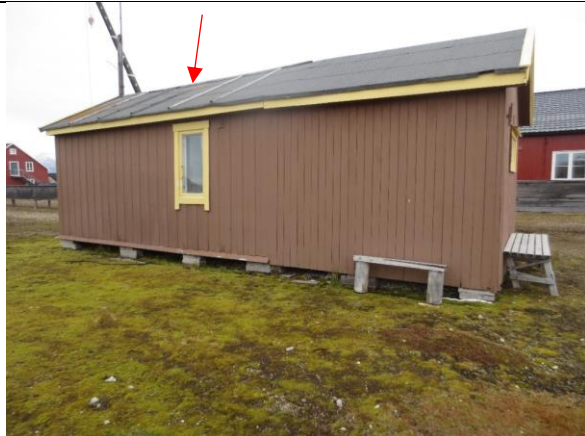
Fasade vest. Rød pil antyder et rustent beslag, antatt etter eldre røykrør. Vinduet stammer fra ombyggingen i 2. driftsperiode.
