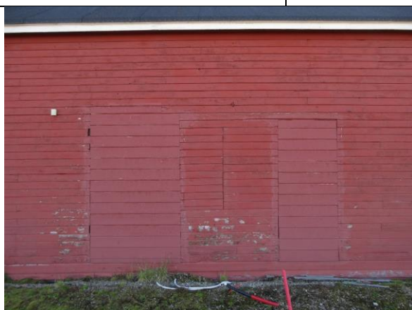
Midtre del av fasade vest, der tidligere dører/vindu er blendet. Interessante spor etter tidligere endringer.
