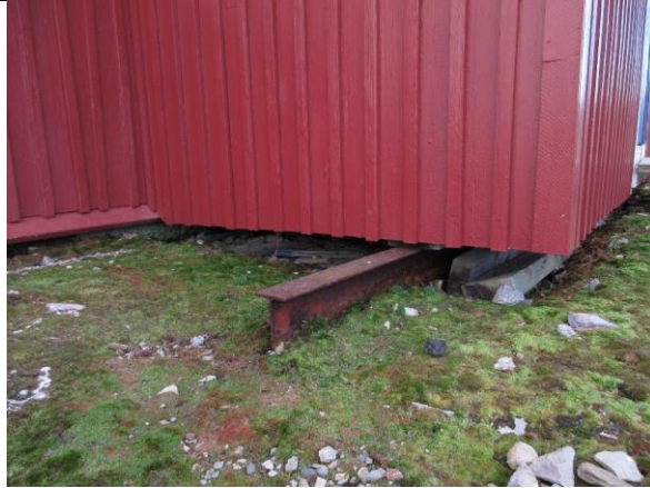
Tilbygget fra 1992 er fundamentert på en I-bjelke og enklere trefundamenter/sviller. Støpt grunnmur under hele opprinnelig lagerbygning.
