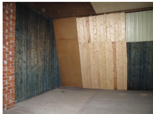
I 2. etasje ses ny panel der et sekundært oppløst i takflata mot sør nylig er tettet. Opprinnelig panel har blålig grunning. Foto: Siri Hoem 2010
