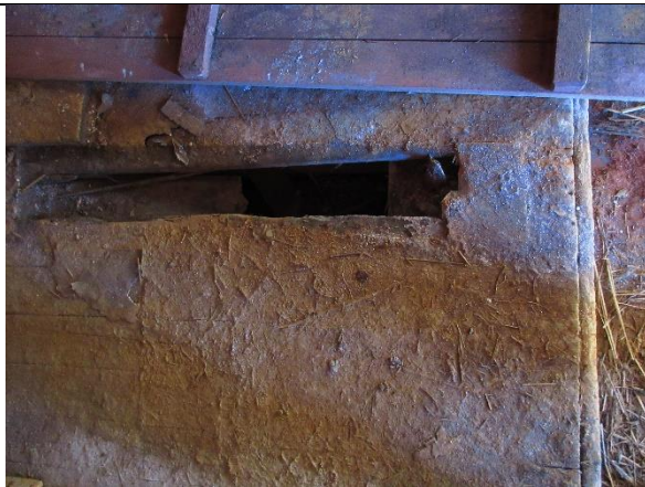
Detalj av gulvene i de to bygningene, t.v. vestre del med hull i bordgulvet. Årsak kan være brekkasje, lite råte er påvist. Til høyre gulv i lemrakka. Det er en liten nivåforskjell/list mellom gulvene.
