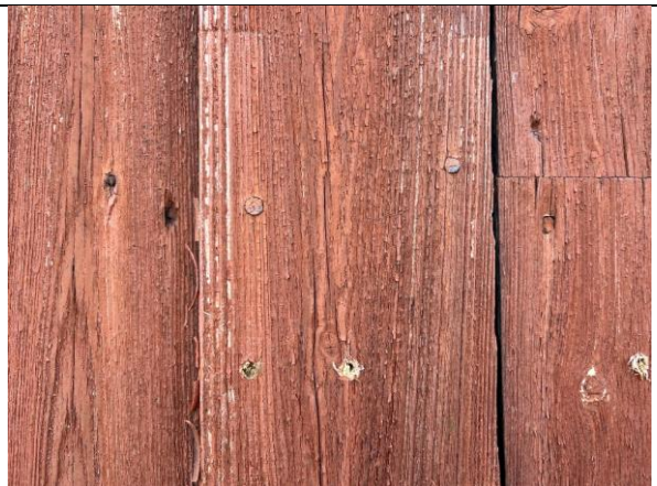
2024: Det er ulike typer spiker i opprinnelig kledning, innslått før to strøk rød maling er påført. Muligens ble huset istandsatt og spikringen forbedret før maling.
