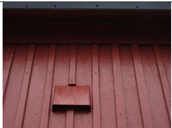
Opprinnelig ventil med beslag, tidstypisk løsning.
