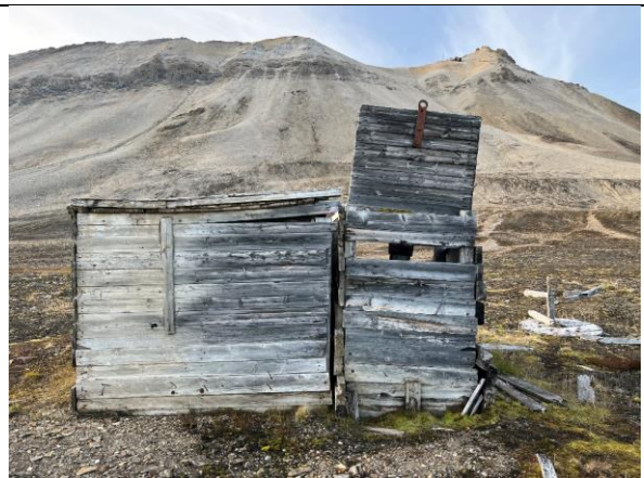
Fasade nord. Merk glippen mellom bordene i øvre del av vegg på varmetua, der den har hengt seg opp på luftesjaktas konstruksjon. Dette ble fikset etterpå, slik at konstruksjonene igjen beveger seg fritt.
