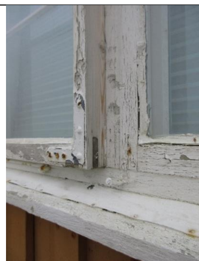
Nye setninger medfører at et vindu ikke kan lukkes. Dette understreker behovet for jevnlig tilsyn og eventuelt justering av fundament.
