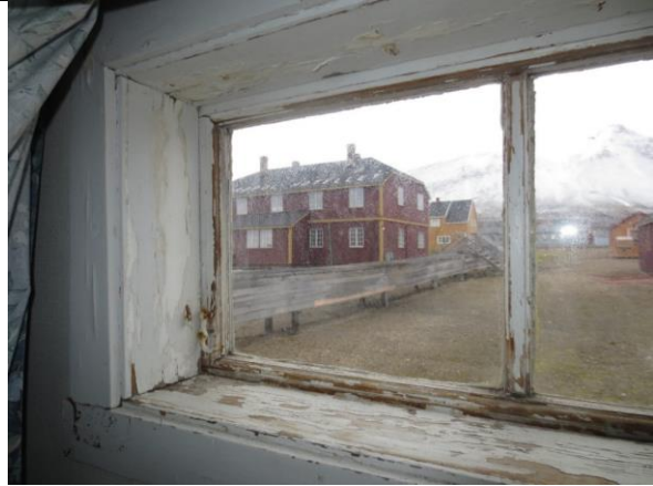
Eldre vindu mot sør, som ikke har varevindu. Staffprofil på ramme og liten, flat kantprofil på sprosser.
