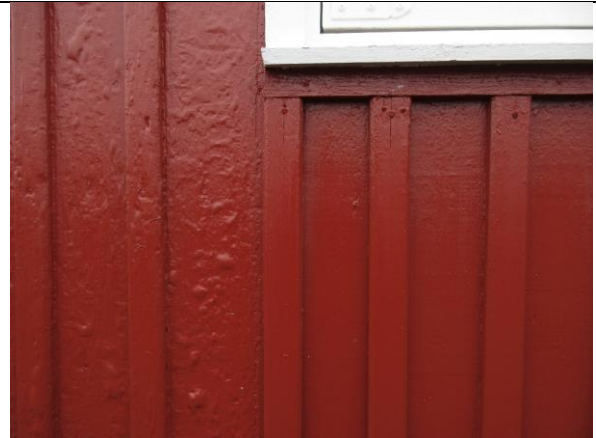
Gammel kledning med omfattende linoljeblæring, årsaken er fet, gammel grunning. Tilsvarende ny kledning under vindu har ikke samme problem.
