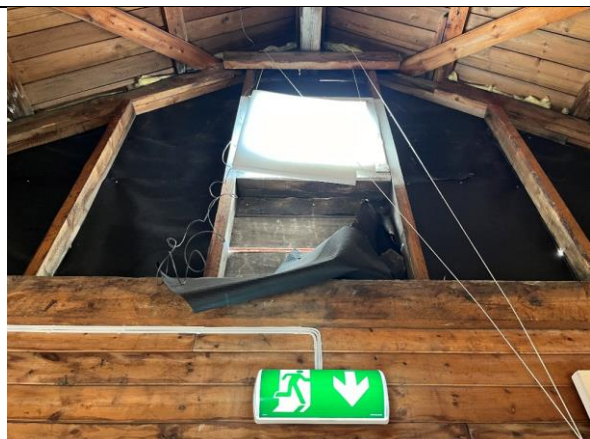
I øvre del av gavl sør er et opprinnelig vindu. Synlig papplag på innsiden av utvendig kledning.
