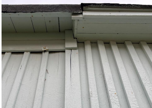
Fasadedetalj i overgang mellom brakkene, tilbygg Ny Mexico t.h. Lektepanelet er tettere montert enn på den opprinnelige svenskebrakka fra 1945, og takutstikket er kledd inn med gesimskasse.
