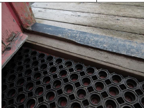
Det er store utfordringer med vanninnsig over terskel med innadslående dør, her forsøkt løst med oppbrettet beslag, som er nedtråkket. Fritt vann er oppsamlet i innendørs gummatte, uheldig løsning.
