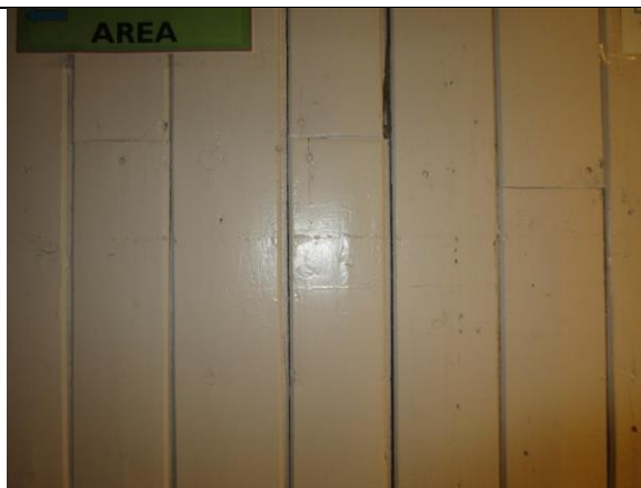
Eldre faspanel i korridor 1. etasje, med spor etter stifting av platekledning, som i 2. driftsperiode ble slått på veggen.
