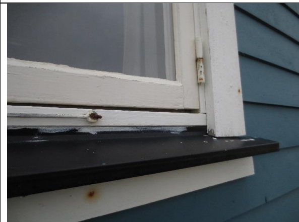
Detalj av nyere koblet vindu i hovedetasjene, ca. 1990, med plastbelagt beslag på vannbrett. Dette beslaget er en nyere og noe skjemmende løsning, som på sikt bør vurderes fjernet.
