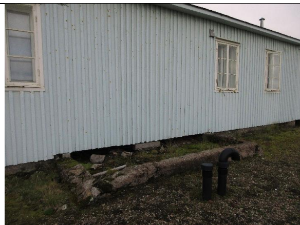
Ny Mexico mot nord. Den støpte grunnmuren til bislaget i bygningen fra 1919 stikker utenfor veggen.
