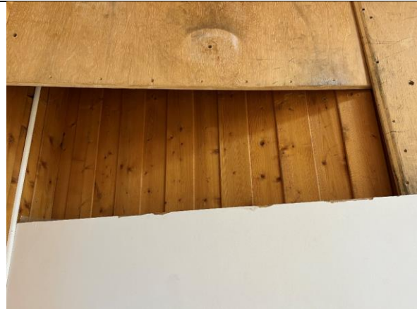
I øvre del av østveggen i gymsalen er opprinnelig vekselpanel fra 1962 bevart. Denne ble fjernet i nedre del ved etterisolering i 2012.
