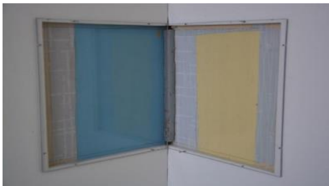
Referansefelt i stue, gammel maling med tapet over. Foto fra restaureringsrapport 2013–14
