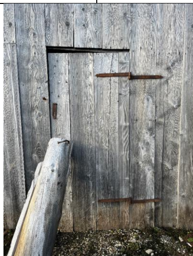
Opprinnelig dør med defekt beslag på dør i søndre naust, fasade øst.
