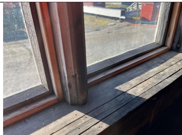
Opprinnelig vindu mot sør, med fint profilert midtpost. Enkle rammer med nyere list på innsiden.
