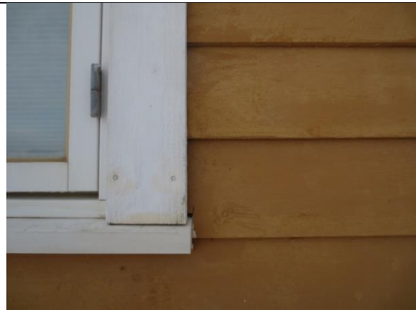
Detalj av vindu med flate gerikter. Små sagspor i kledningen fra vindusutbedringen i 2012, da alle vannbrett under vinduene ble fornyet, og det ble lagt vindtettende papp bak listverket.
