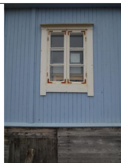
Typisk vindu i boligdel, som etablert i 1929, muligens fornyet ved flytting i 1946, med justert plassering av gerikter, ref. Treider.
