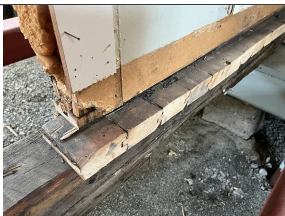
2024: Opprinnelig tregulv ble fjernet i 1. etasje under refundamenteringsarbeidet. Opprinnelig 2'' (5 cm) pløyd plankegulv og bjelke er bevart under skillevegg i stue.
