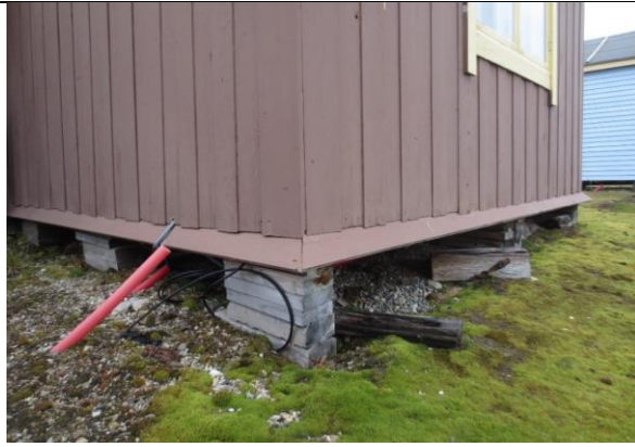
Hjørne nordøst. Fundamentene ble utbedret i 1993-94, dels med høye stabler av plank. Opprinnelig vekselpanel fra 1918 er bevart, likeså løsningen med skråstilt vannbrett med gjæret hjørne.
