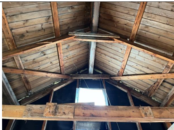
Opprinnelig sperrekonstruksjon med hanebjelke, liggende plank/spikerslag med stående taktro, se også bildet t.v.
