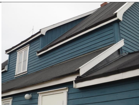
Møte mellom takformer på takoppløft og bislag/tilbygg mot sør. All takpapp ble fornyet i 2014.
