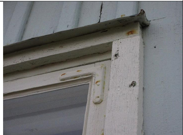
Vinduene fra 1945 har vannbrett av sinkbeslag over.
