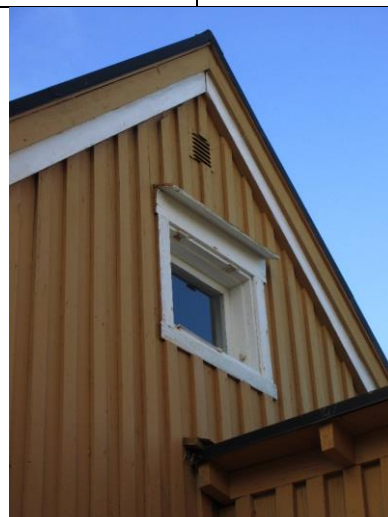
Yttervinduet i gavl øst er fjernet og må erstattes.
