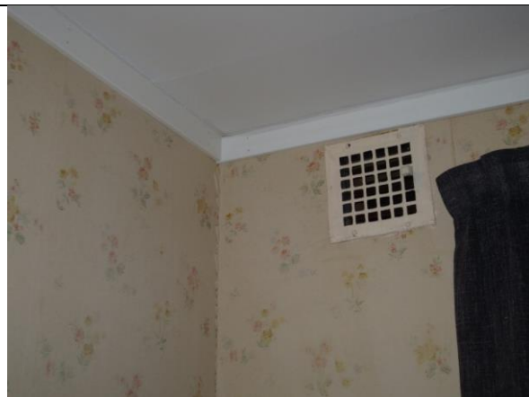
Tidstypisk jernrist fra 1950-tallet på innside av ventil mot nord i soverommet.
