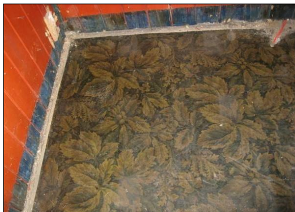
Avdekket linoleum i spisestua, antatt fra perioden som Nordpol bar. Blålig grunning på panel under rød maling. Foto: Siri Hoem 2011
