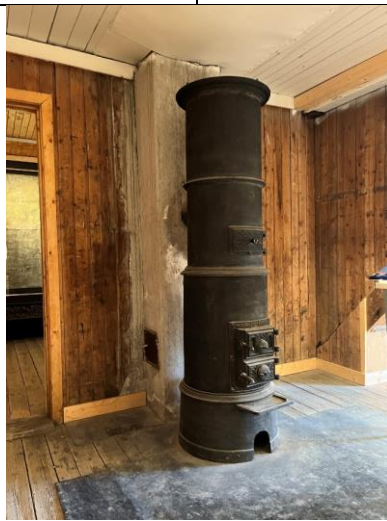
Pusset pipestokk og rund jernovn, type 195 fra T.M.V. Eldre blikkplate på gulv og i himling. Feieluke av støpejern fra Ulefos i pipestokken.
