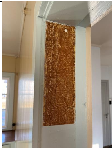
Avdekket ådring (malt etterligning av finere treslag) på dørkarm mellom kjøkken og ekspedisjon.
