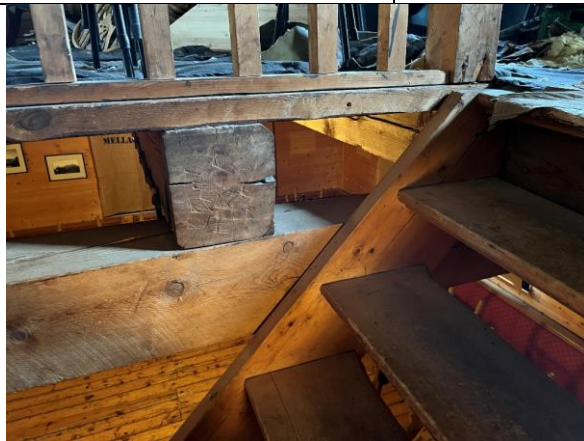
Krysslågt bjelkelag mellom 1. etasje og loftet. Trapp og eldre rekkverkstype rundt åpningens i loftsgulvet.
