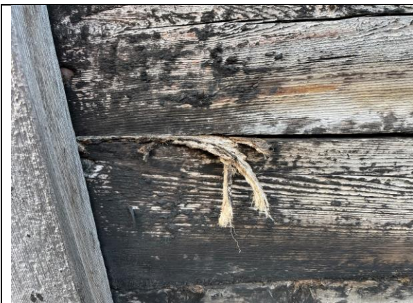
Detalj av kullpram fasade øst, rester av tjærebehandling på overflata og tjæredrev som tetting mellom plankene.
