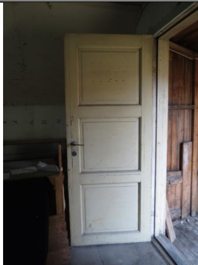
Fyllingsdør mellom bislag vest (t.h.) og tidligere boligdel. Typisk dørtype fra 2. driftsperiode.
