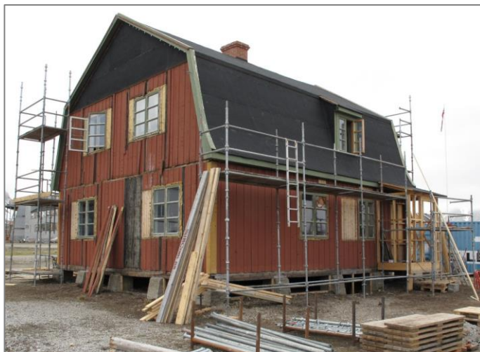
Under tilbakeføring. Opprinnelig kledning er avdekket ute, med tydelige spor etter flytting av vinduer. Foto: Siri Hoem 2010
