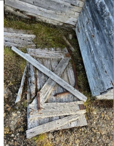
Luka som har stått i luftesjakta, ligger på bakken nedenfor. Rester av beslag viser at luka har vært topphengslet.
