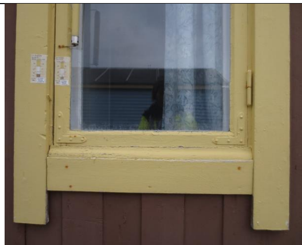
Nedre del av det høye vinduet på vestveggen, med samme detaljer og beslag som vinduet mot nord. Vestvinduet er en endring fra ombyggingen til familiebolig i 2. driftsperiode. De lange geriktene som går ned på sidene av vinduet gjenkjennes på foto før istandsetting i 1993.
