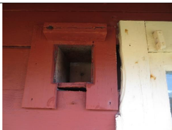
Ventil ved siden av vinduet i boligdelen, sekundært skåret inn i listverket ved vinduet. Kanalen har innvendig fôring av nyere trefiberplate.
