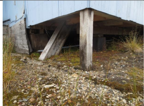
Tilbygget del av bislag mot vest fra 1954 står på enkle peler uten ytre skjørt. Det lille tilbygget har ikke vannbrett under kledningen.
