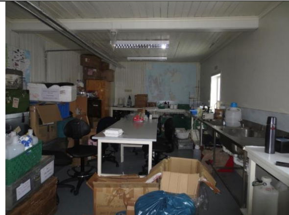
Laboratorium i nordre del av 1. etasje, sett mot vest. Veggene har dels nyere platekledning. I himlingen ses bjelke etter utveksling av opprinnelig bærevegg.
