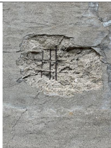
Detalj av mekanisk skade i yttervegg fra 1949, med tynn ytre puss og avdekket armeringsjern.
