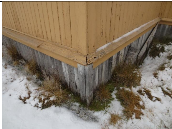
Vannbrettet er hevet et stykke opp på opprinnelig kledning, en dårlig teknisk løsning, der vann renner bak vannbrettet. Løsningen ble etablert i 2. driftsperiode. Skjørt av ulike typer stående bord.
