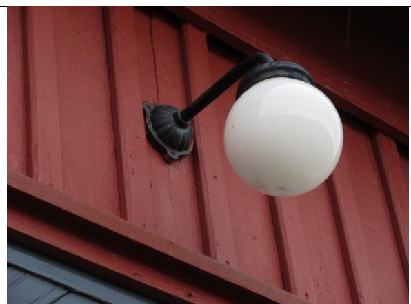
Eldre lampe over hovedinngangen mot øst, antatt montert i 2. driftsperiode.
