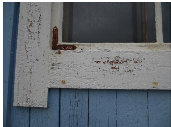
Detalj av vindu øst i bislag. Underliggende rødbrun maling på geriktene (fasaden var malt grårosa). Pløyd faspanel.
