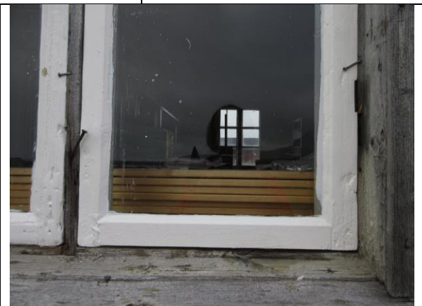
En del rammer er nylig restaurert og malt, men hjørnejern/hengsler/hasper er ikke remontert.
