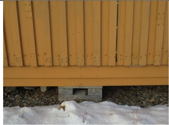
Nederst på fasaden ble det tilført to liggende bord i forbindelse med refundamentering og utbedring av råteskader i 2013. Spikerfestene i nedre del vitner om at kledningen på østveggen ble demontert da veggen ble etterisolert i 2013.
