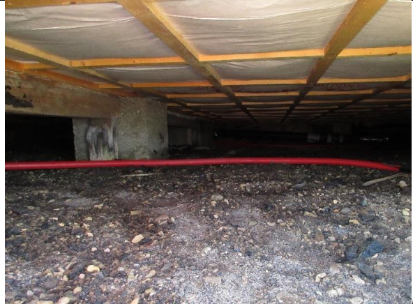
Ved restaureringen i 2009–11 ble dekket mot terreng etterisolert på undersiden. Det er betongpilarer som bæring under bygningen.
