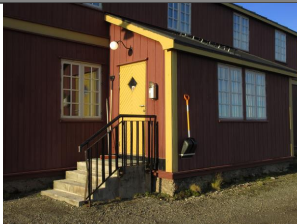
Bislaget har opprinnelig form, men døra ble flyttet til østveggen (mot veien) i 1998. Ny dør og støpt trapp.
