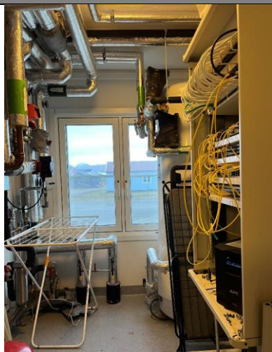
Teknisk rom mot vindu i nord.
