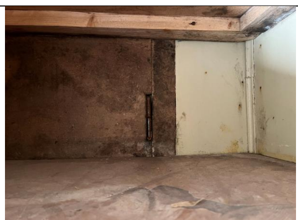
Inne i skap i bislag ses en blendet døråpning mot sør (antatt i bruk 1929–46). Enkel kanthengsel. Dørblad og geriktfeltet er kledd med trefiberplater.
