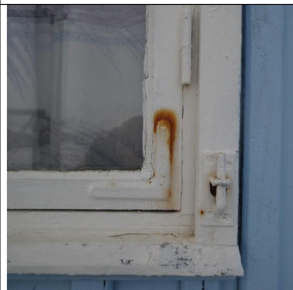
Detalj av opprinnelig vindu, koblet utførelse. Formpresset hjørnejern, antatt svensk fabrikat (samme type ble brukt på funksjonærboligene i 1919). Hengsel for vinduslem i karm.
