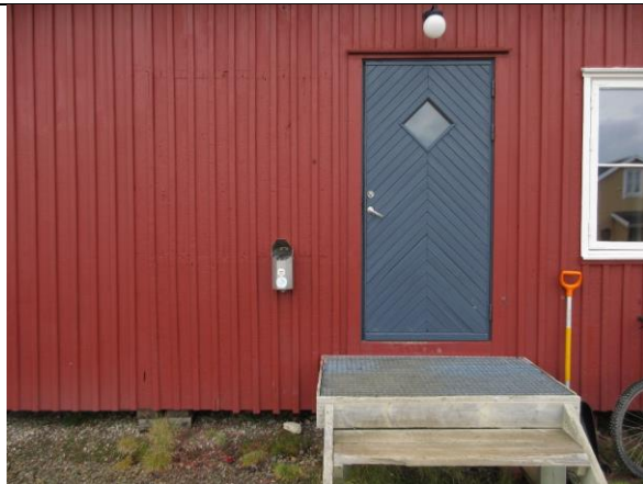
Hovedinngang mot øst. Spor i kledning etter blendet vindu t.v. for døra.
