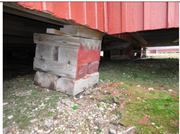
Bevegelser i grunnen gir stadig skjevheter i fundamentene. De er fleksible, men her er det snart på tide med oppretting.
