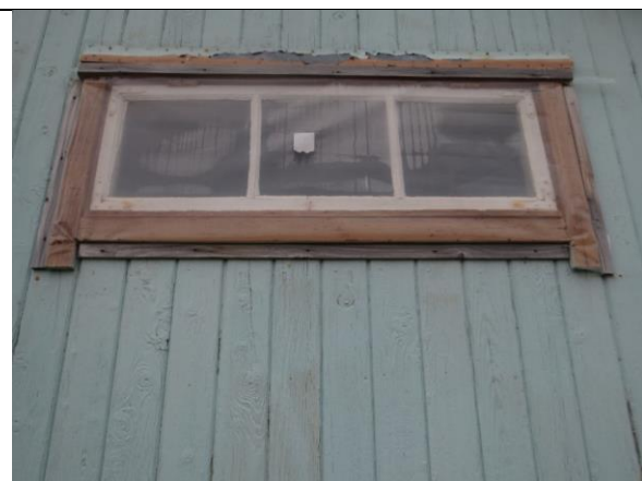
Toppengslet vindu mot øst, åpningen ble etablert i 2. driftsperiode. Her dekket med plast. Vinduet er egentlig en stående vindusramme, typisk bruk av vinduer i 2. driftsperiode i Ny-Ålesund. Noe provisorisk utførte gerikter med supplerende belistning under og på sidene.
