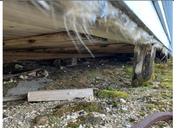
Det er lufting under gulvet. I forgrunnen henger det ned fiber fra isolasjonsmatten bak den nyere utlektete kledningen. Avstivende svill midt under husets lengderetning, på tvers av bjelkelaget.
