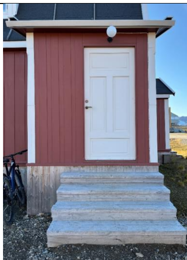
Rekonstruert bislag mot vest. Situasjonen stemmer med slik det var i 1. driftsperiode.
