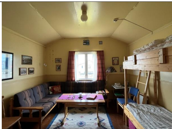
Stua sett mot nord. Platekledningen må være lagt utenpå opprinnelig panel (pløyd faspanel). Typisk modernisering fra 2. driftsperiode. På nordveggen er en jernrist/ventil og sikringsboks, antatt fra 2. driftsperiode.
