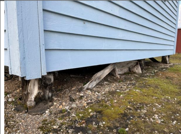
Hytta er fundamentert på trepeler med skråstivere. Antatt opprinnelig fundamenteringsprinsipp med flere bevarte elementer fra 1918. Enkelfalset slaget kledning.
