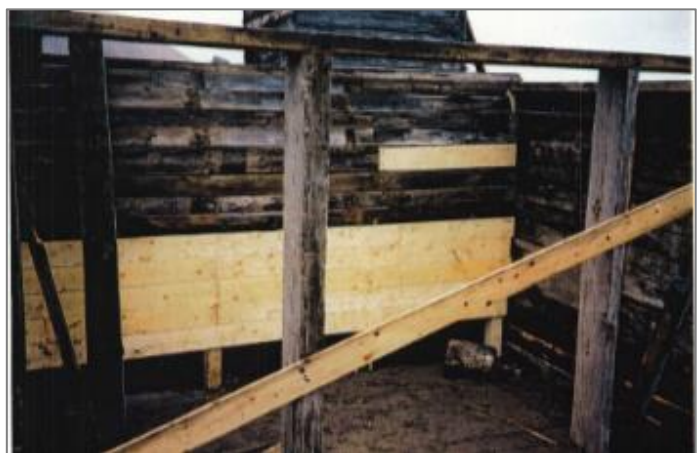
Under istandsetting 2004. Nytt trevirke i vestveggen antyder grad av utskifting. Flere foto hos Sysselmesteren. Kilde: Sysselmesterens arkiv
