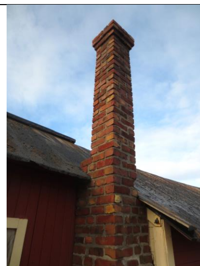
Pipestokken mot nord står i overgangen mellom de to sammenbygde husene, oppmurt ca. 1927.
