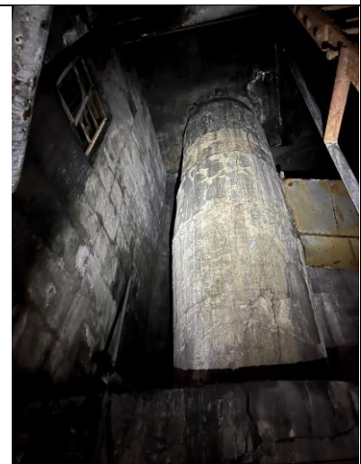
Øvre del av pipa fra 1928. Til venstre yttervegg fra 1949, med vindu mot sør.
