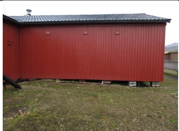
Nordveggen i tverrfløyen. Fire vinduer er blendet, med ny vekselpanel i full høyde. Tre opprinnelige ventiler med beslag er bevart.
