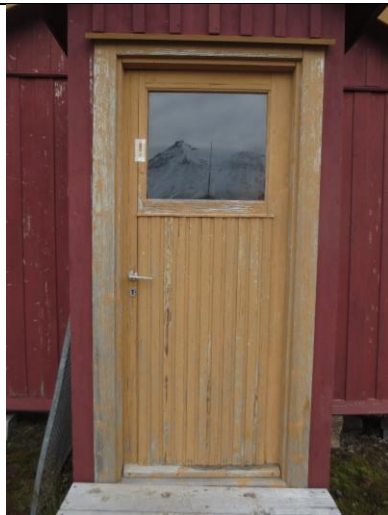
Inngangsdør i bislag er satt inn her etter 1988, gjenbruk av dør fra 2. driftsperiode. Ombygget fyllingsdør, se innside.
