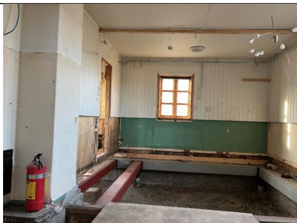
2024: Oppholdsrom sørvest i 1. etasje, etter refundamentering og riving av skillevegg. Sett mot vindu i sør.
