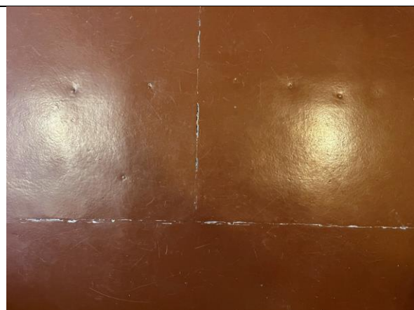
Malte huntonittplater på gulv i soverom og oppholdsrom, som etablert i 2. driftsperiode.
