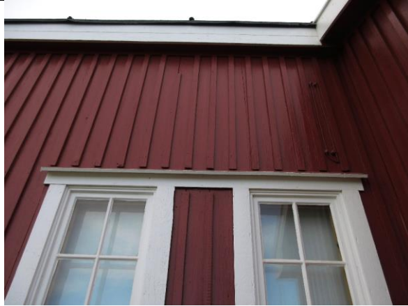
Nyere/tilbakeført vindusfelt mot nordvest (til venstre for tilbygget), der lektene over/under vannbrettet er noe dårlig tilpasset. Tradisjonelle lekter med rundt tverrsnitt på taket.
