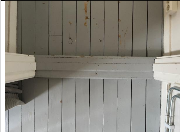
Malt bordgulv i 1. etasje.
