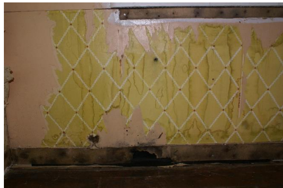
Eksempel på tapet avdekket under arbeid i 2008. Kilde: Kings Bays arkiv.
