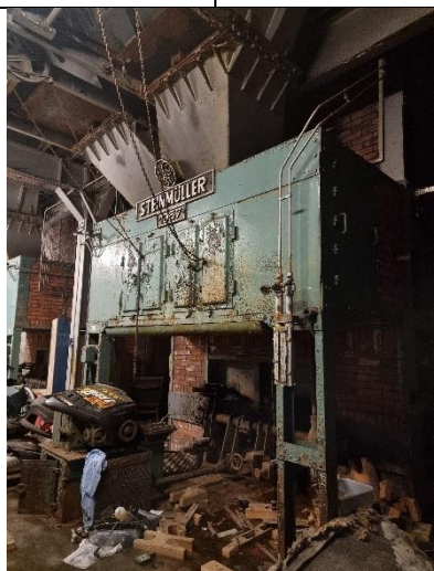
En ovn med skilt Steinmüller 1957. Foto: Kings Bay AS 2023.
