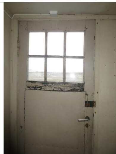
2023: Innside opprinnelig dør i bislag øst, fyllingene er isolert med en innvendig huntonittplate. Forgangen er kledd med malte plater fra 2. driftsperiode.
