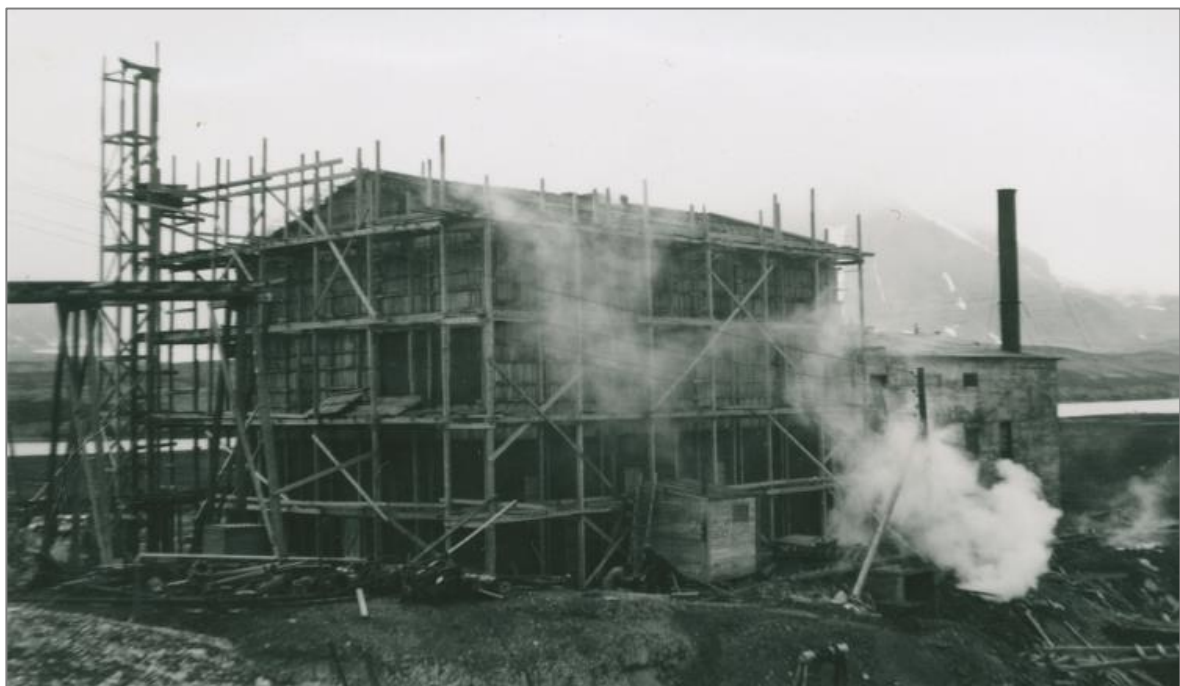
Under bygging i august 1949. Her oppføres det store overbygget over fyrkjel og silo fra 1928. Bak stillasene ser vi forskalingen for betongveggene. Disse to bygningsvolumene fra 1949 er del av dagens anlegg. Foto: Ukjent, Svalbard museum, SVF 00084
