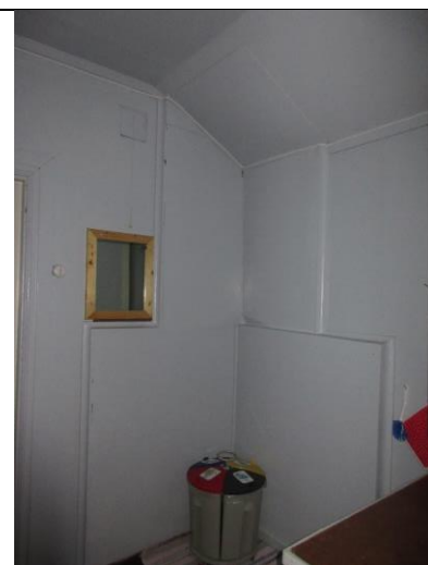
Sørvestre hjørne i kjøkken har spor etter ovns plass. Brannvegg av malte eternittplater og plate i taket, der det har vært røykrør.
