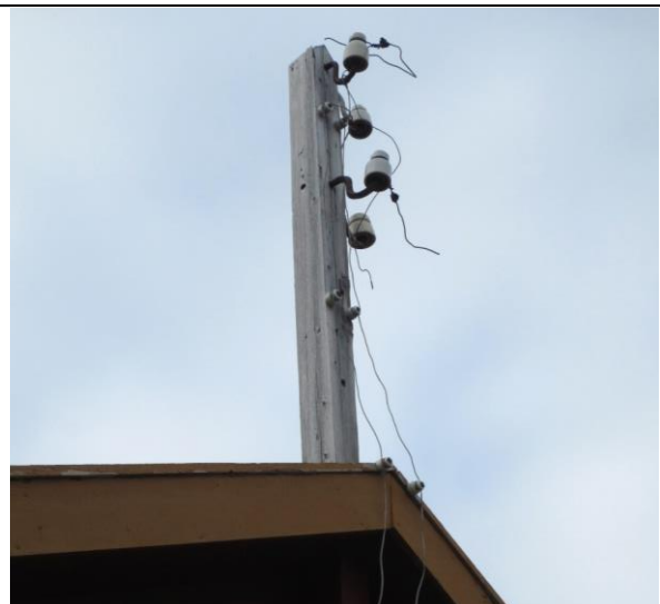
Mast med rester av elektrisk anlegg med luftspenn mot nord. Høy verneverdi.
