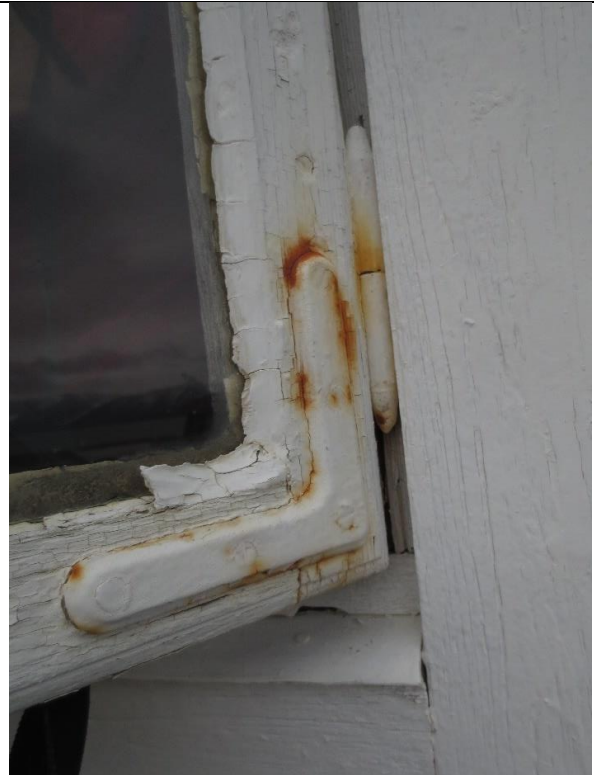
Loftsvinduene har opprinnelige formpressete hjørnejern og hengsler med konisk tupp, typisk for vinduer fra 1. driftsperiode i Ny-Ålesund (som loftsvindu i nr. 21 Hvitt hus).
