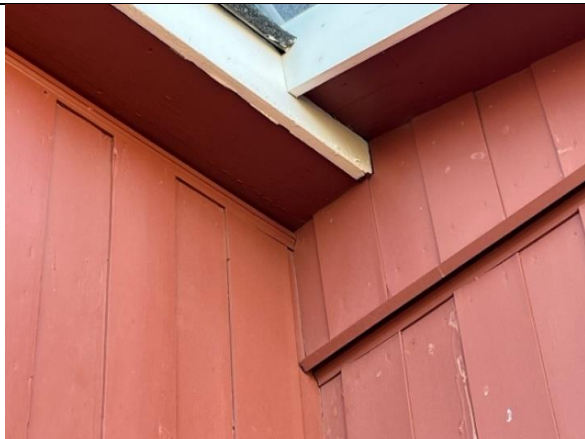
Til venstre opprinnelig vekselpanel og øvre list med karnissprofil anno 1918. Til høyre rekonstruert bislag mot vest.
