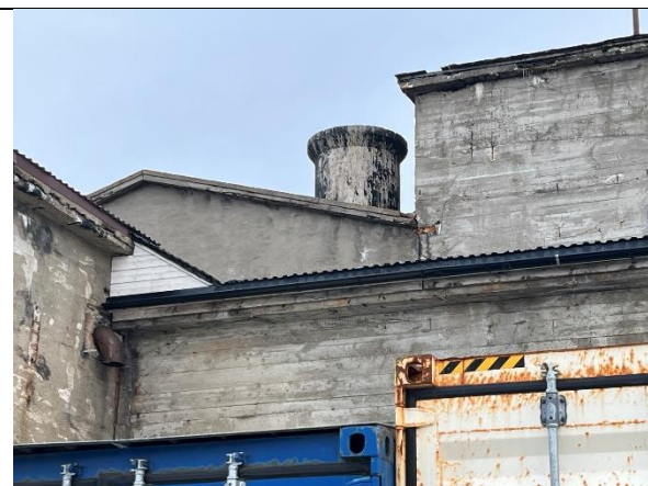
Utsnitt av de fire bygningsvolumene sett fra nord, med den runde pipa som antas å være bevart fra 1928.
