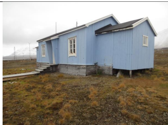
Fra nordvest, boligdelen. Vi ser de to byggetrinnene i bislaget, der tilbygget fra ca. 1954 mangler skjørt rundt pelefundamentene. I nedre del av opprinnelig vegg i bislag er en malt luke for tømning av dobøtte. Luke til kullbinge i tilbygget er dekket av ny kledning.
