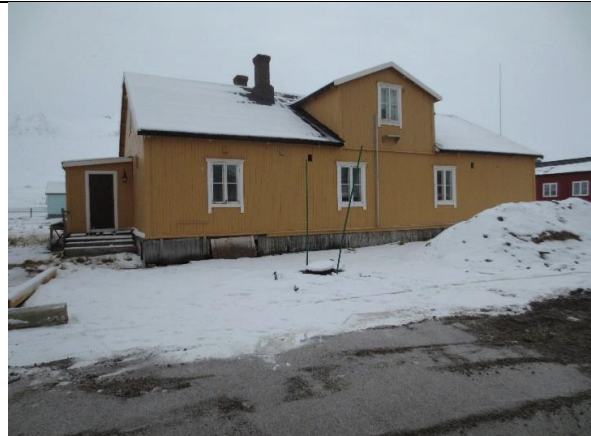
Fasade nord. Helt til venstre nedenfor vinduet skimtes ei list, som markerer skjøtt kledning der ei rørgate har gått inn.
