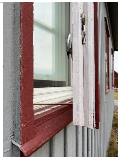
Opprinnelig vindu i koblet utførelse (to rammer/glass). Nytt varevindu med isolerglass innenfor.
