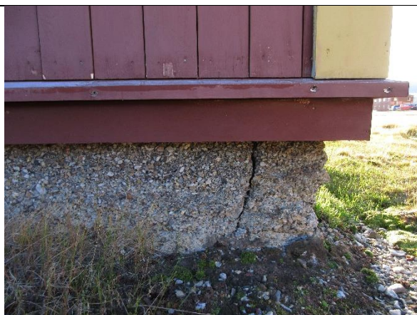
Opprinnelig grunnmur med lokalt framstilt betong. Overflata er svært værslitt, slik at tilslaget (lokal strandgrus) eksponeres. Et par sprekker i muren. Økt tining av permafrost kan by på framtidige utfordringer. Vannbrett og kledning er gjenskapt, men detaljeringen avviker fra opprinnelig utførelse.
