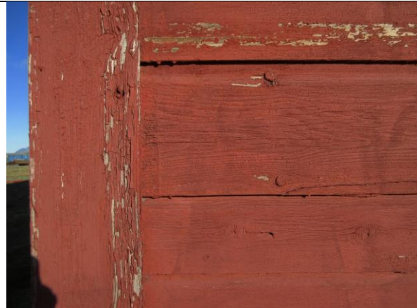
Detalj av opprinnelig liggende kledning fra 1919 på sørveggen, dobbelfalset liggende kledning med noe bredere bord enn i første byggetrinn fra 1917.
