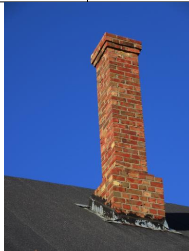
Høy pipe i takflata mot øst, plassert ved innervegg mot butikken. Murt med pølsefuger (dratt med avrundet jern). Pipa er fra 1. driftsperiode.
