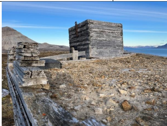
Noe grus er lagt tilbake på taket etter restaurering med ny takpapp under. Tidligere røykrør er fjernet over tak, kasset inn og kledd med papp.
