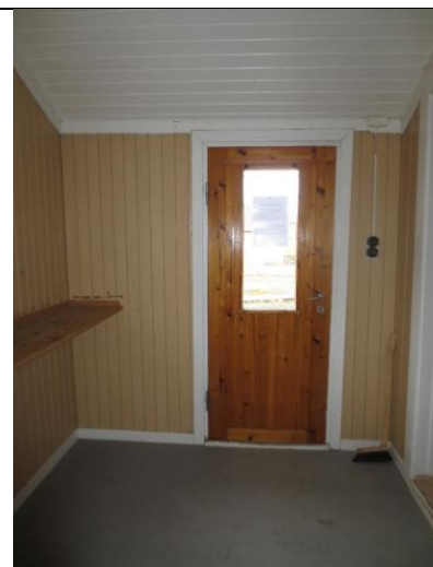
Innside av inngangsdør mot nord i bislaget. Døra har lakkert innside og er av samme type som flere inngangsdører i Ny-Ålesund fra 2. driftsperiode.
