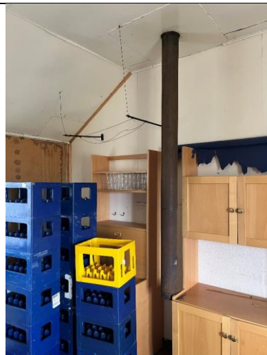
I kjøkkenet ved skillevegg mot sør henger piperøret løst, ovnen er fjernet. Piperøret er beholdt til over tak.
