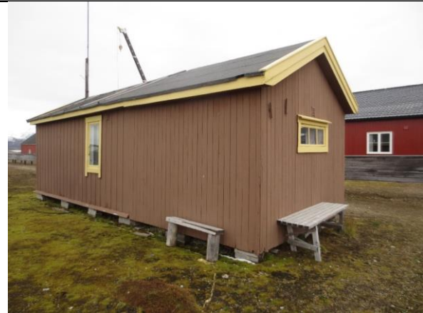
Fasade vest og gavl mot sør. Nordre del er den opprinnelige seksmannsbrakke, se skille i vannbrett mot tilbygget i sør.
