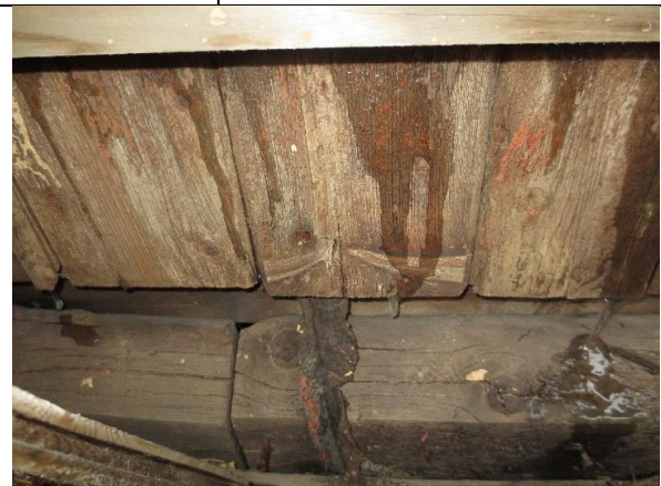
Nær hjørne sørvest har ytre skjørt falt av, nedre del av kledning har rester av rødmaling. Opprinnelig vannbrett lå med innstikk under denne kledningen. Vann renner nå inn bak det hevede vannbrettet.
