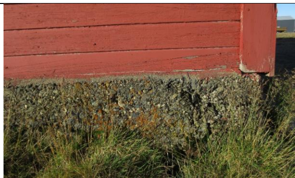
Ringmur av betong med forvitret overflate.
