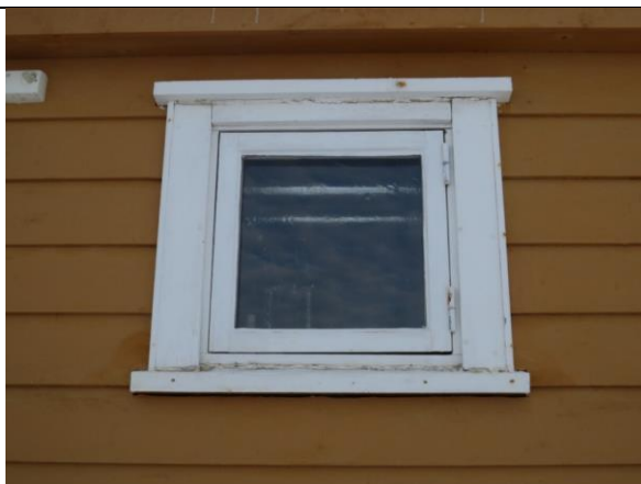
Ettrams vindu i bislaget mot vest. Dette er noe eldre, hengsler og gerikter har mindre avvik fra de øvrige vinduene.
