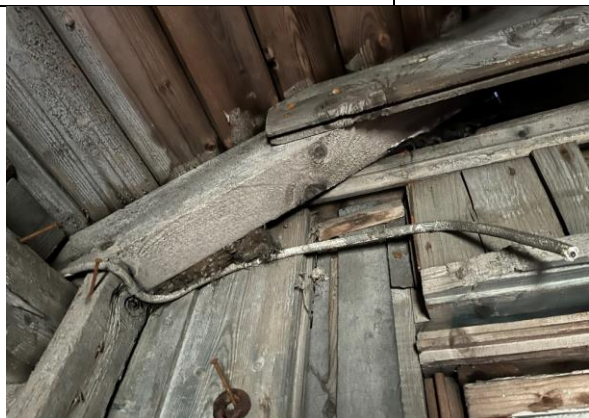
Stender i vegg og takspærre i opprinnelig bislag sett mot hovedbrakkas sørvegg. Opprinnelig vekselpanel på hovedhytta ses på siden av døra inn til kjøkkenet.
