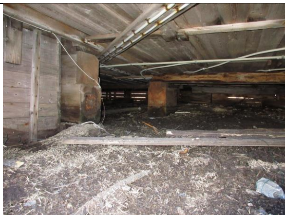
Under huset, med fundamenter av liggende boksbitar og ytre skjørt av lemmer t.v. Stubbloftets underside er kledd med over-/underliggerbord.
