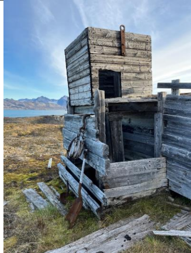
Luftesjakta har en god del skader, og ei luke har falt ned. Rustne rester av spader står utenfor.
