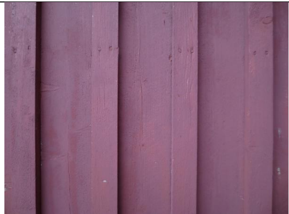
Ny lektepanel på bislaget, som ble gjenoppbygget 1987. Paneltypen mangler historisk belegg i denne konteksten. Opprinnelig bislag hadde faspanel.
