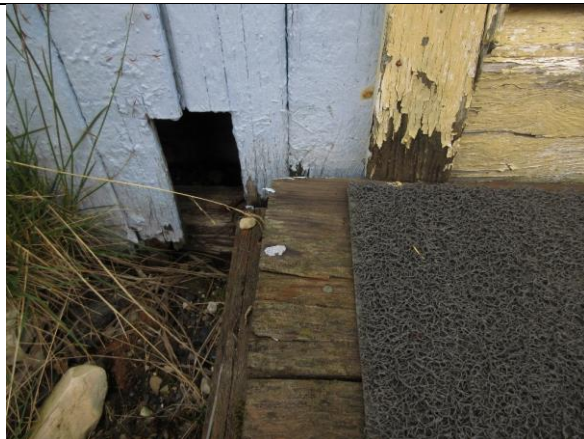
Bislaget/tilbygget i sør er fundamentert med sviller rett på bakken. Fundamentet er skjult bak kledningen.
