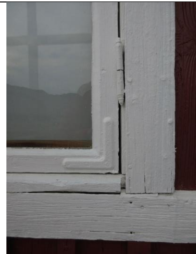
Detalj av hengslet vindu, med opprinnelig eikenøtthengsel og formpresset hjørnejern.
