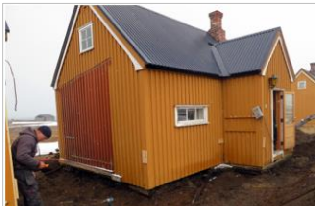
Rødmalt yttervegg avdekkes der tilbygget (med do) har stått. Foto: Herrmann 2014
