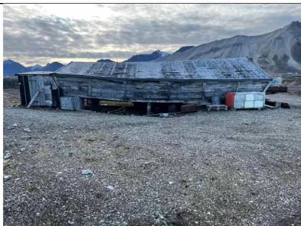
Kullpramnaustet sett fra nord, med betydelige setninger og nedbøyning. Situasjonen har utviklet seg over lang tid, ref. foto foran fra 1949.
