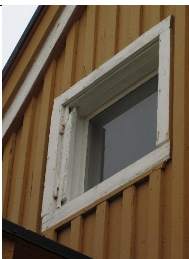
Vinduet i vestre gavnl mangler ytre vindusramme, kun varevindu står inne i karmen. Vann trenger inn.
