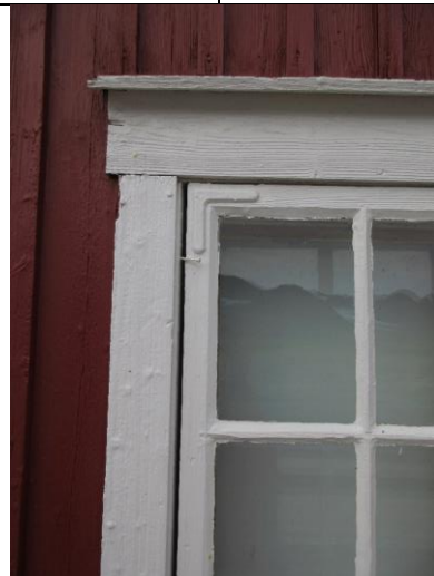
Noen av vindusrammene er hengslet, andre er spikret fast. Typiske detaljer med opprinnelig formpresset hjørnejern.
