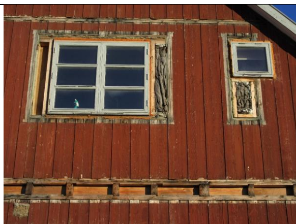
2024: Detalj av fasade vest. Tydelige spor etter opprinnelige vinduer og gerikter anno 1919, jf. eldre foto.
