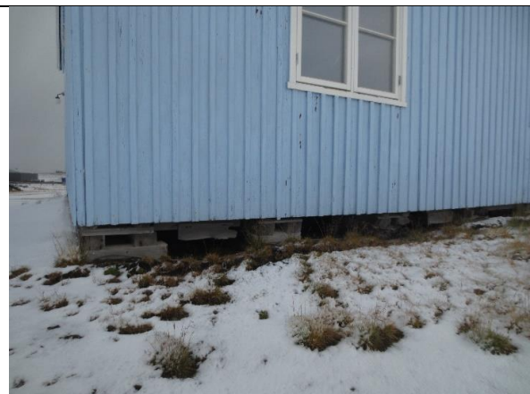
Hele vestre del av bygningen er fundamentert på trepakninger, som utsettes for mye bevegelse i tinende permafrost.
