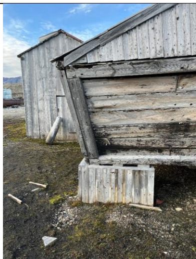
Fasadeutsnitt øst, med innkasset fundament og kullprammens skrå vegg. Tilbygget nast ses bak.
