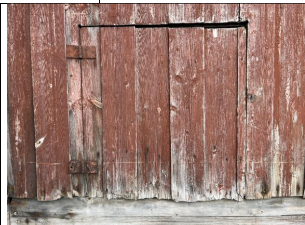
Detalj av luka vist t.v. Den er sagt ut sekundært uten tilpasning til vekselpanelet. I hvert øvre hjørne ses runde spor etter forboring før saging.
