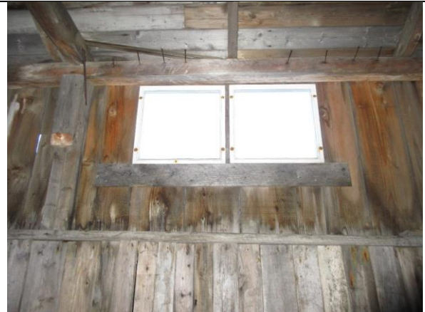
To små vindusrammer i naustets nordvegg, de vender ut over kullpramnaustets lavere tak.
