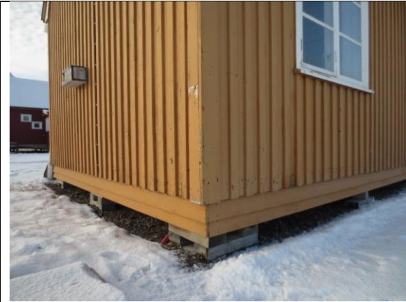
Huset ble refundamentert i 2013. Det ble hevet opp fra terrenget og lagt på nye tømmerpakninger.
