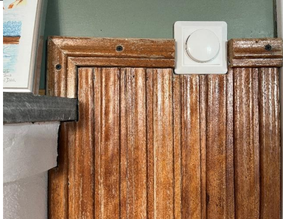
Detalj av 1950-talls brystningspanel ved peisen. Uheldig montering av nyere lysbryter.
