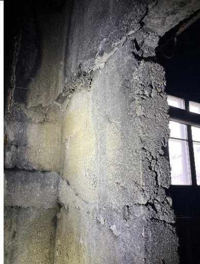
Vegg fra 1949, åpning mot tilbygg fra 1957. Betongen er innvendig isolert med tresnittplater og puss.
