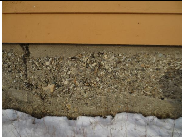
Detalj av opprinnelig grunnmur av lokalt framstilt betong. Sementen i overflata er slitt vekk og tilslaget av lokal strandgrus kommer til syne.
