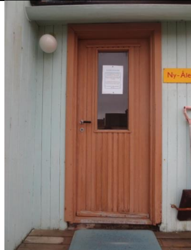
Døra har kledning og bakelitthåndtak typisk for etterkrigstida.
