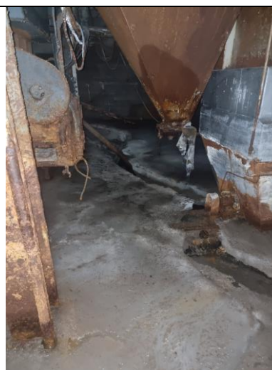
Is fyller deler av kjelleren. Foto: Kings Bay AS 2023
