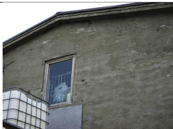
Vindu i vestvegg, lav fløy fra 1949. Mye avskalling i ytre pusslag.
