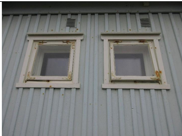
Topphengslete vinduer med hjørnejern og ventiler i vegg, som etablert ved installering av to bad/WC i 1957–58.
