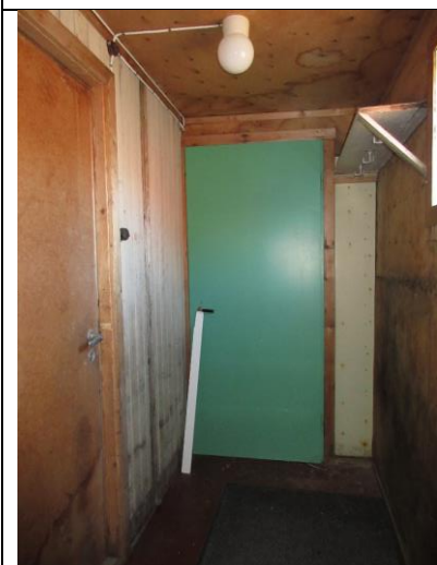
Bislag vest fra ca. 1954. Nymalt dør mot sør, ellers er interiøret bevart med alderspreg. Opprinnelig yttervegg i bislag fra 1929 t.v., med bevart lys grågul maling. Umalt flate bak fjernet dekkbord, ref. foto ca. 1947 foran.
