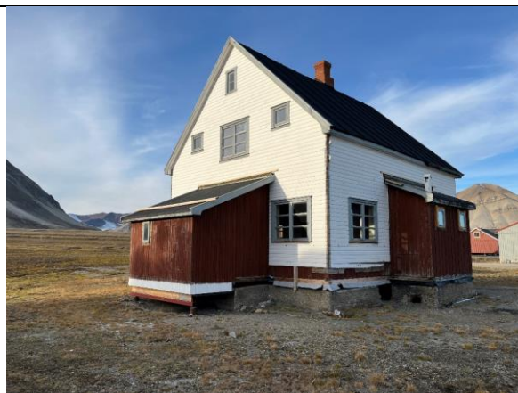
2024: Liggende kledning er fjernet på bislagene. Begge bislag står på opprinnelig ringmur, men tilbygget til bislag øst står på peler, her etter refundamentering på stålpeleer.
