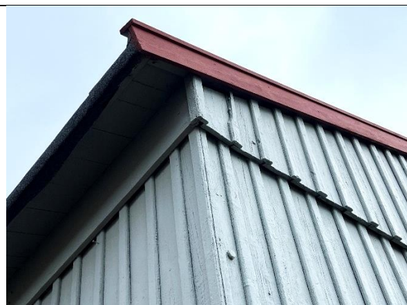
Panelskjøten i gavl er markert med et nivåsprang. På langveggene er et felt med liggende bord under takutstikket, som opprinnelig i 1945.
