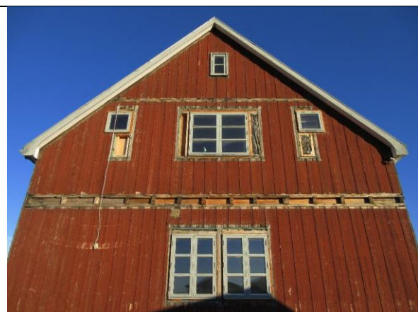
2024: Fasade vest. Spor etter opprinnelige og nye vindusåpninger og listverk. Kun loftsvinduet er bevart fra 1919, de øvrige er endret i format. Mellom etasjene ses gulvbjelker, gesimsbåndet ble fjernet før påslåing av liggende kledning i 1959.
