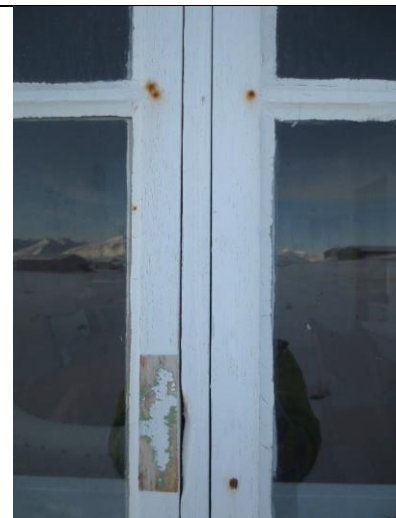
Rester av grønn maling er avdekket under den hvite malingen på vindu mot nord.
