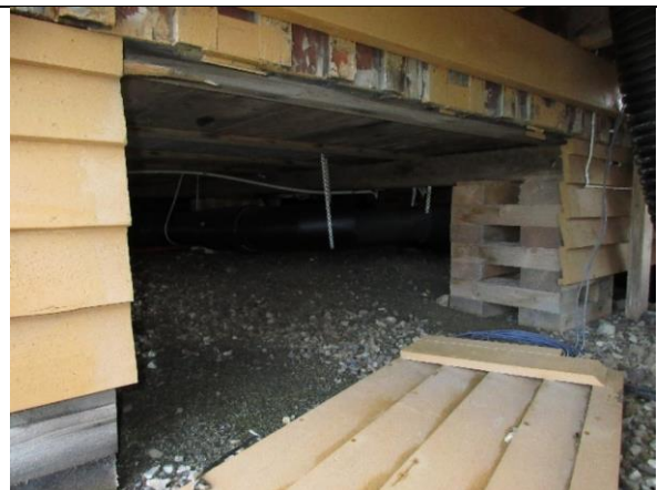
Fundament med trepakninger under dotilbygg. Rester av eldre rødming på hovedhusets kledning.
