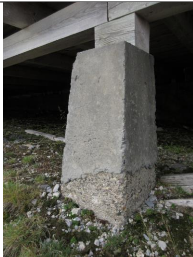
Opprinnelig støpt pilar under plattingen, der betongkvaliteten anno 1919 skimtes i nedre del. Senere reparasjon med standard sement.
