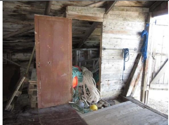
Avdelt rom med gjenbruk av eldre dør sør for porten i kullpramnaustet. Et parti foran porten har plankegulv.
