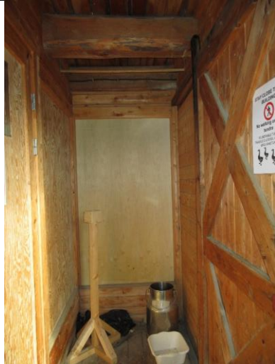
Interiør i nyere vindfang. Til høyre skimtes skyveporten mot sør, labankkonstruksjon med jernskinne/hjul over.
