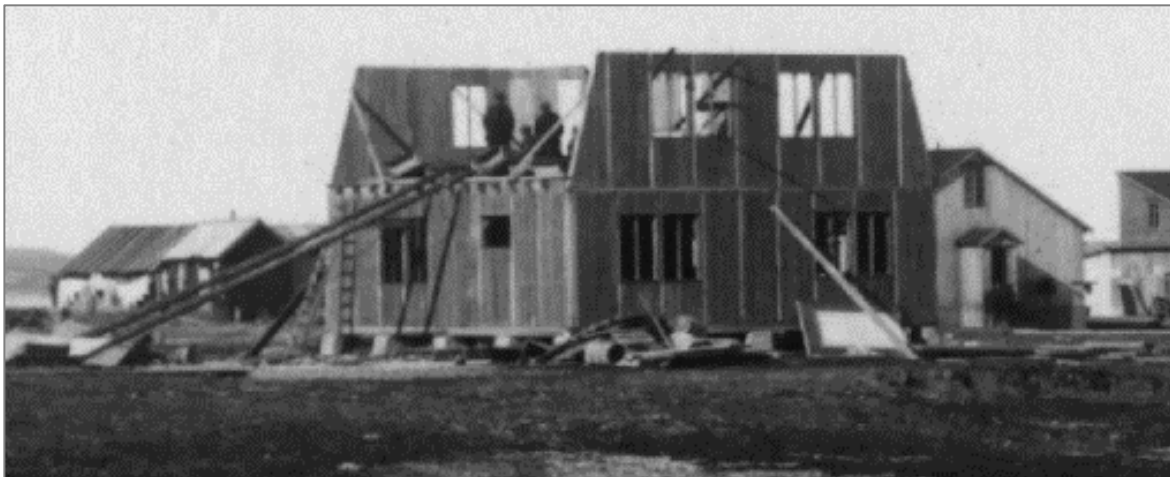
Villaen under oppføring i 1918. Vi ser lemmene (med papp uten ytterkledning), der stenderne deler opp de parstilte vindusfeltene. Foto: Sigvald Moa, Norsk Polarinstittutt, np003100 (utsnitt)
