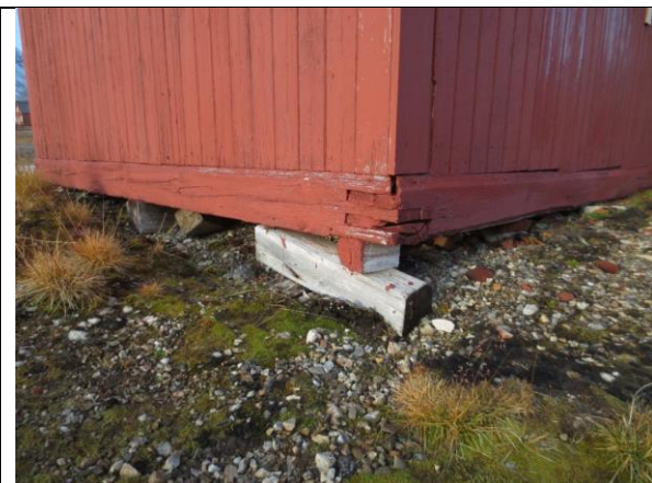
Østre del: Bunnsvill med dobbel sliss/tapp og gjæret sammenføyning i hjørnene. Utglidd fundament av boks under hjørne nordøst. Setninger på nordveggen avslører overgangen mellom lemmene som små nivåsprang.
