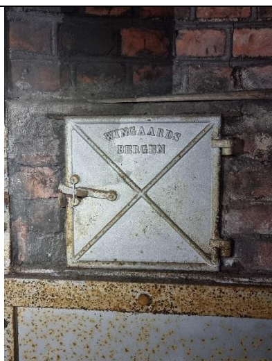
Feieluke i ovnen fra 1957, Wingaards jernstøperi i Bergen. Foto: Kings Bay AS 2023
