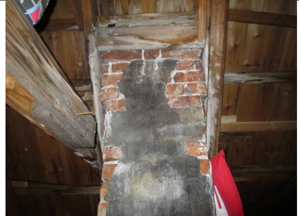
Pipestokk med rester av puss, antatt murt med en kalkrik mørtel fra 1919.
