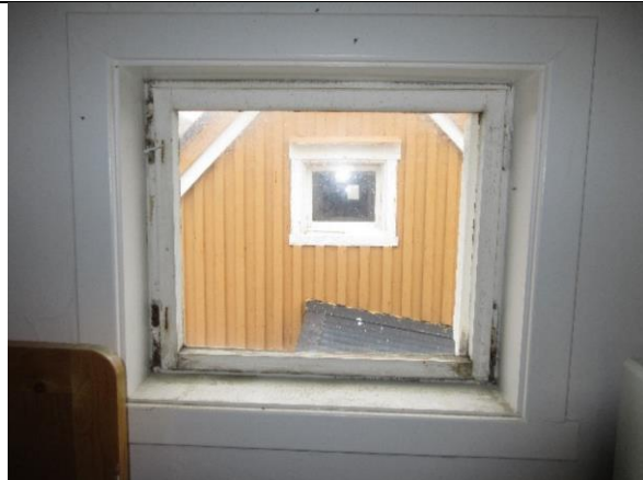
Vindu mot vest har kun varevindu, ytre vindusramme er demontert og må erstattes.
