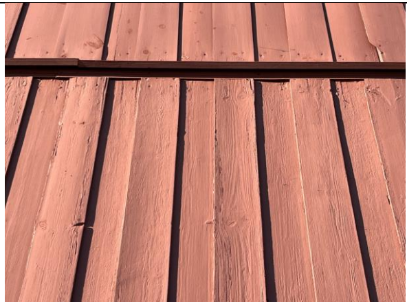
Detalj av opprinnelig vekselpanel. Gjenbrukte bord er værbitte, nye bord over gesimsbåndet (i gavl).
