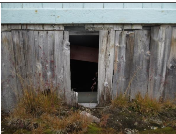
Hull i skjørt fasade øst, her et eldre parti med pløyde bord. Merk upresis avslutning av kledning bak liggende list, dette tyder på endringer.
