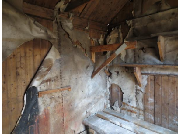
Hjørne nordøst, med pløyd faspanel på vegg og rester av hvit papp på innsida. Kraftig svill i øvre del av vegg, der lemmene er slisset inn. Fast innredning og eldre materialer i malerboden har høy kulturhistorisk verdi.
