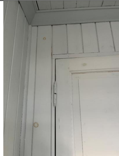
Detalj av innvendig panel og innerdør, dels bevarte elementer og dels rekonstruksjon.
