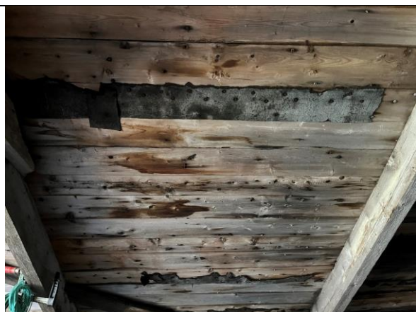
Utsnitt av takflate mot nord, med liggende taktro og biter av papp.
