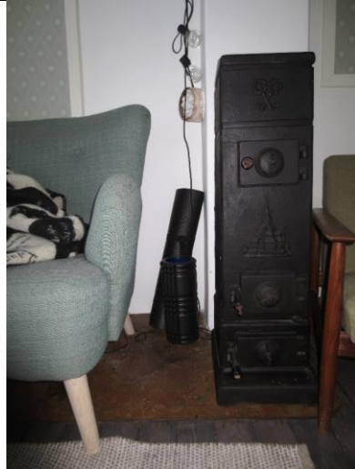
Dagens ovn er løsrevet fra pipa, del av piperør ses oppe til venstre.
