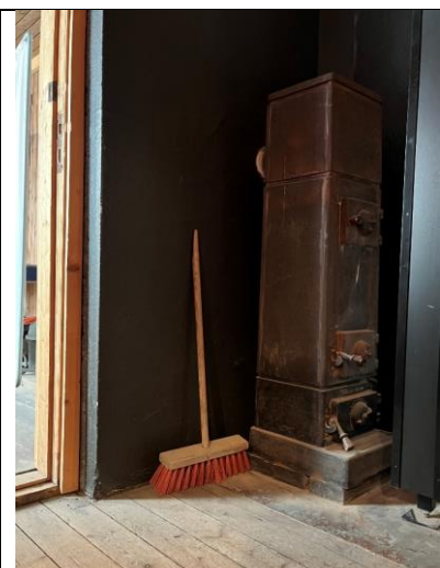
Gammel jernovn i butikklokalet, ved siden av døra til tidligere kontor. Ovn er type nr. 402 fra Trolle. Eldre blikkplate på gulv, lagt over en huntonittplate.
