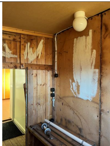
Interiør i bod mot øst, åpen labankdør til gang/bislag fra 1946. Platene i himlingen måtte fornyes grunnet store vannskader.
