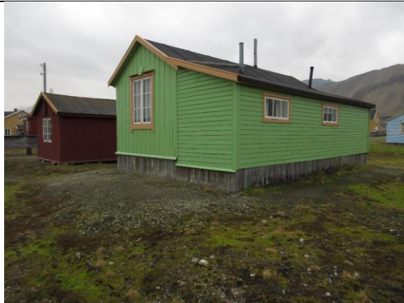
Fra nordvest, opprinnelig del fra 1919 til venstre. Tilbygget mot vest er oppført i tre omganger og kledd med liggende kledning. Lengst til høyre på langveggen har det vært et tilsvarende liggende vindu, senere blendet og skjult av ytre kledning.
