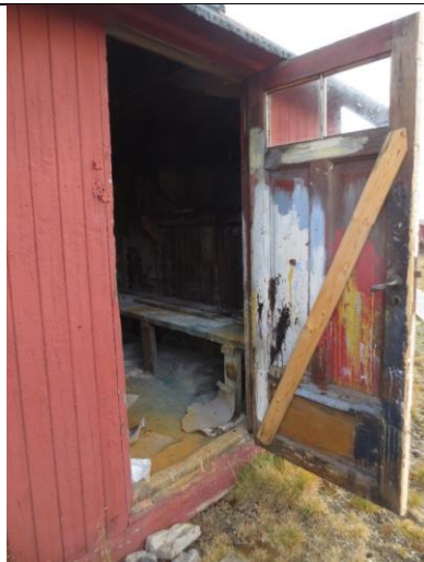
Innside av fyllingsdør mot sør, inn til malerboden. Prøveoppstrøk maling (eller penselrens) har svært høy verneverdi.
