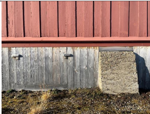
Skjørtet mellom de støpte pilarene har stående bord, som opprinnelig. Det er etablert nye inspeksjonsluker.
