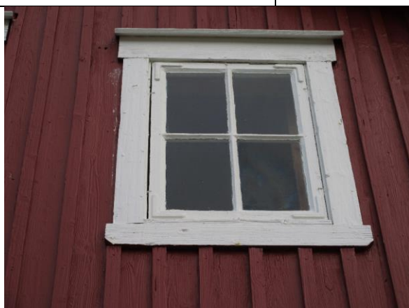
Typisk vindu i loftsetasjen, opprinnelig ramme med formpressete hjørnejern og tidstypiske geriker med skrånkjært nedre hjørne.
