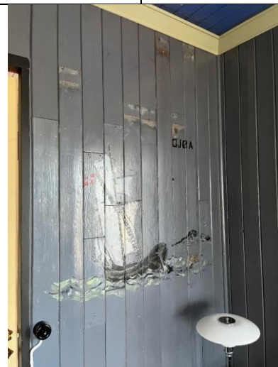
Panelbordene tilhørende Gjøa var dels kappet opp og brukt til tetting av et vindusfelt, her satt tilbake på antatt opprinnelig sted.
