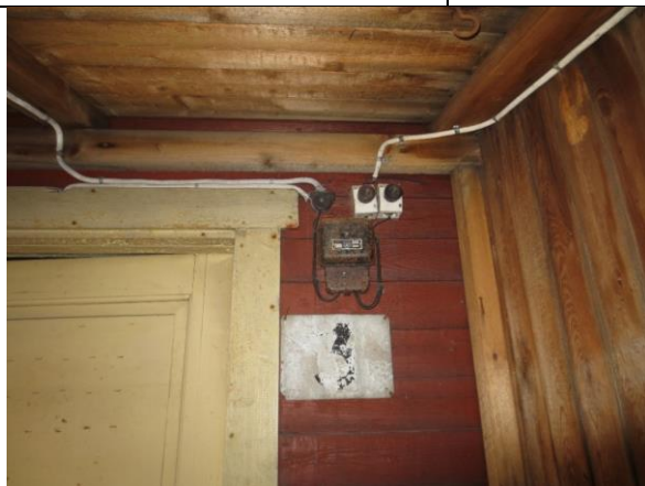
Opprinnelig yttervegg inn mot bislag i vest, dør til boligrom. Skiltplate påmalt nr. 3 på yttervegg før oppføring av bislag. Bevaringsverdig el-anlegg.
