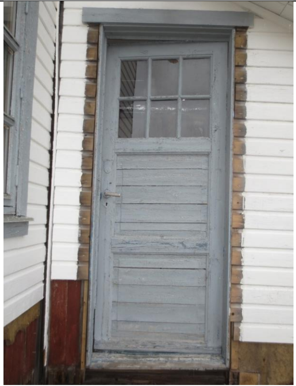
2023: Bislag øst. Opprinnelig fyllingsdør med sprossedelt vindusfelt anno 1919. Sprekker mellom bordene i fyllingene. Istandsetting må skje nennsomt uten tap av verneverdier.
