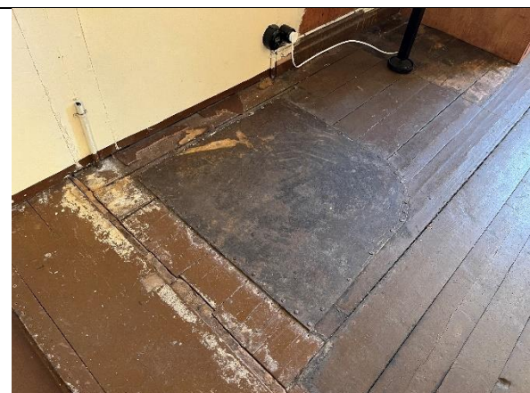
Opprinnelig malt bordgulv i telegrafrommet. Spor etter tidligere ovns plass i forgrunnen, nordvest i opprinnelig bygning fra 1918. I forgrunnen ny åpning i opprinnelig (ytter-)vegg etter at tilbygget hus ble oppført i 1929.
