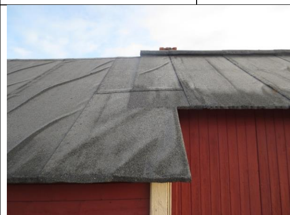
Utsnitt av takflate sør, i overgangen mellom de sammebygde husene. Opprinnelig mønekam på østre hus. Takpappen er brettet rundt taktroa med spikersøm i endeveden.
