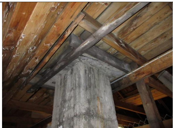
Gammel pipestokk over vegg mot den tidligere butikken. Teglmur med puss.
