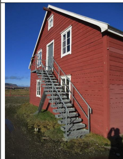
Rømningstrapp av stål fra 2015 i søndre gavl.
