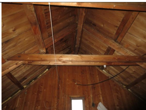
Opprinnelig takkonstruksjon på loftet. Sperrebind med spinkle dimensjoner og hanebjelke av to plank boltet fast på hver side av sperrene. Takstrø med barkkant og stående tro.
