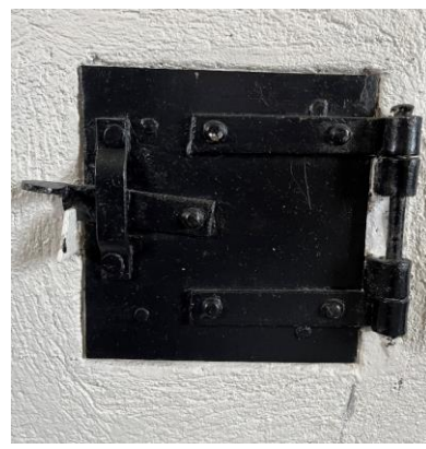
Hjemmelaget feieluke i brannmur i stue.
